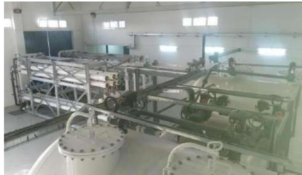
Les filtre a cartouche station d'IFRIGARA Figure 21 : Bâtiment de traitement de la station d'IFRIGARA
