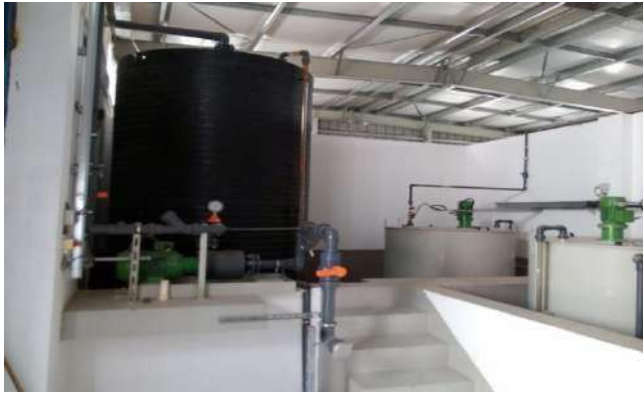
Bac de stockage de chlore
