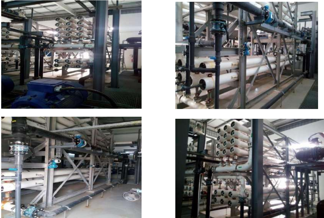
Figure30: Unité d'osmose et de l'osmose inverse
