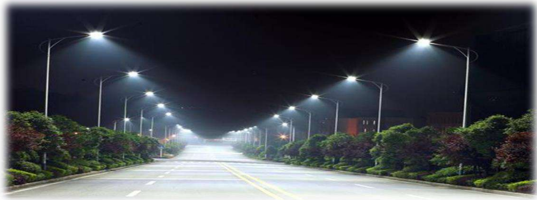
الشكل (II-10): صورة توضح إنارة طريق سريع
