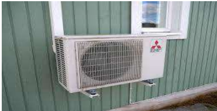
Figure 2-2: Refroidissement par climatiseur
