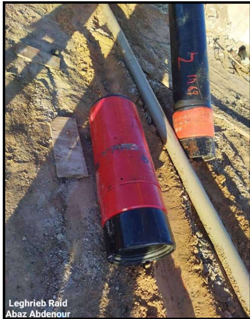
Photo N°35: Le DV (Diverter valve).
