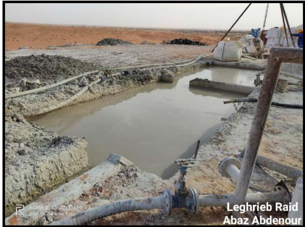
Photo N°22: Les fosses à boue.
