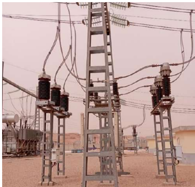
Figure I.15 TC 60kV à gauche, TT 60kV à droite au niveau de GRTE Ouargla.
