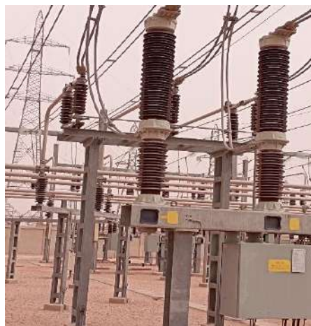
Figure I.16 Disjoncteur 60kV au niveau de GRTE Ouargla.
