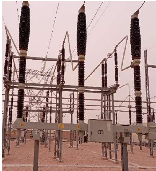
Figure I.17 Sectionneur 220kV au niveau de GRTE Ouargla.
