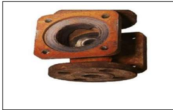
الشكل (I - 2): صورة لتآكل المنتظم [11]
