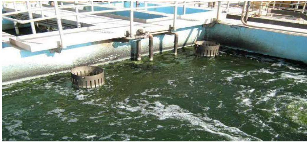
Figure 3 : Bassin de dénitrification puis filtration
