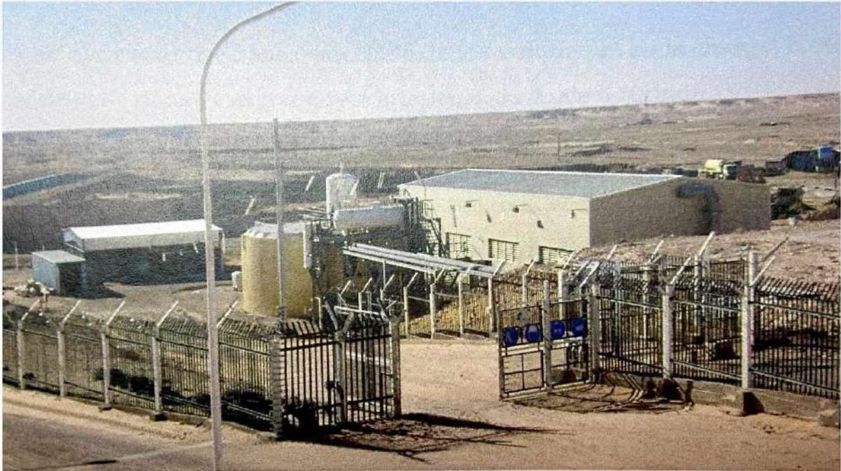
Figure 1: Station de déshuilage de Haoud-Berkaoui
