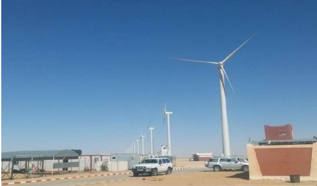
Figure I. 15 : Centrale éolienne d'Adrar
