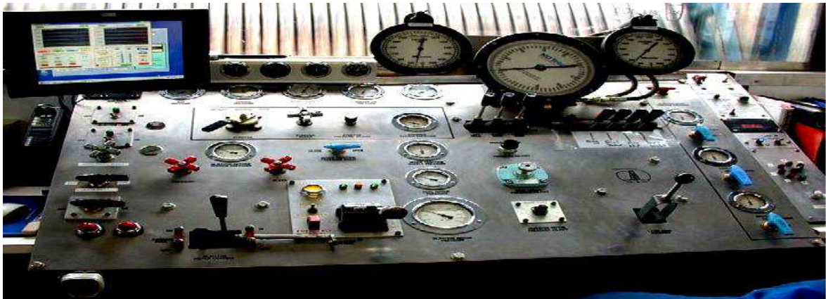
Figure II-6 : Cabine de contrôle
