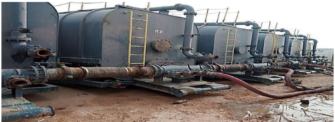
Figure1: Réservoir d'eau (fractank). [8]
