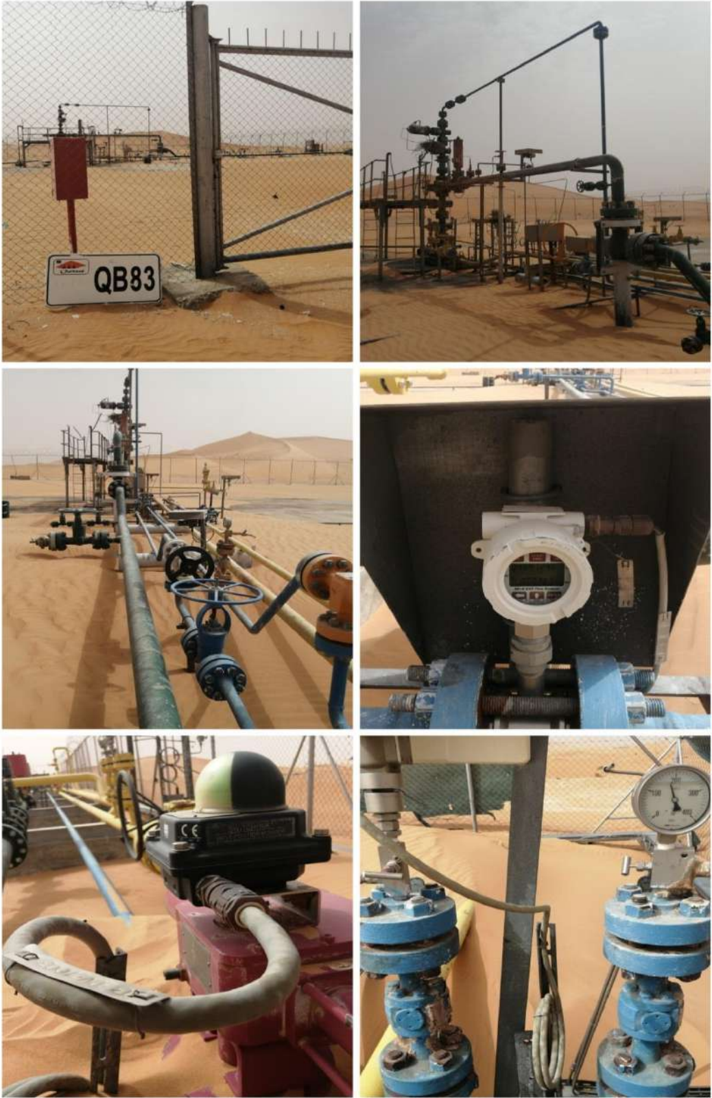
Fig E.1 : L'installation de surface de puits QB83
