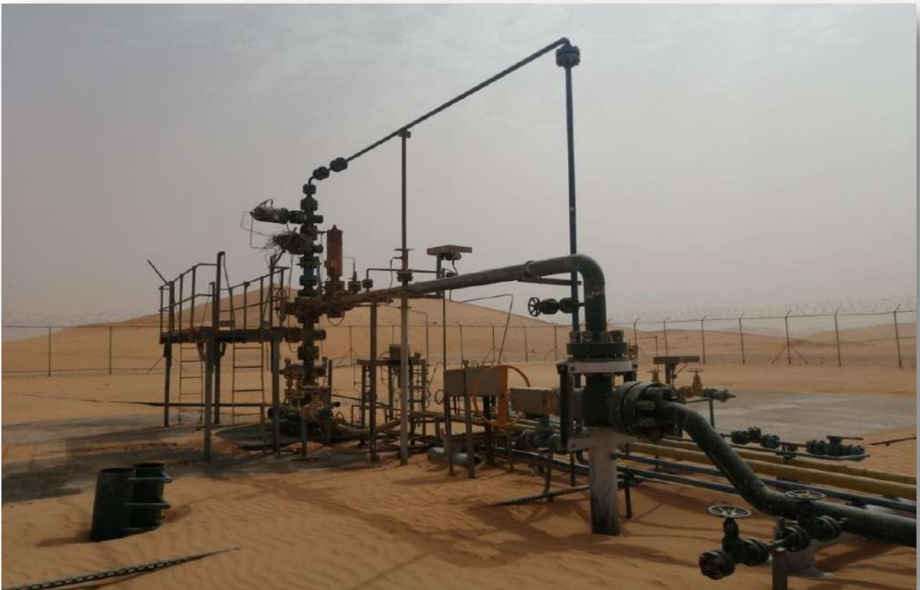
Fig III-8 : Tête du puits (Vannes Autres Equipements)
