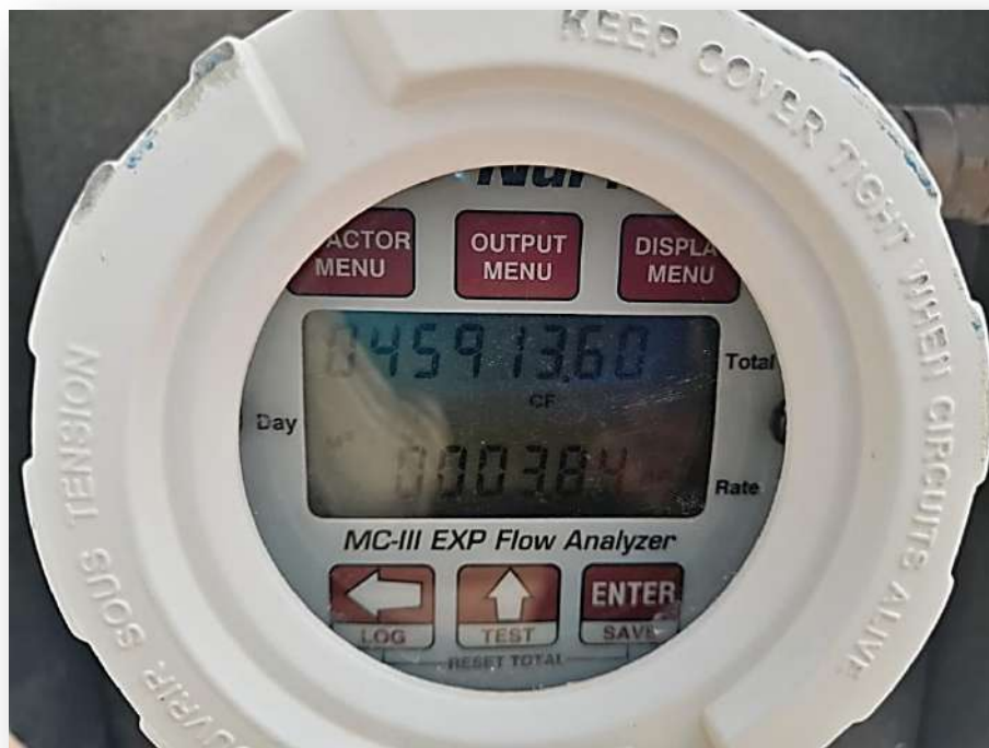
Débitmètre de l'eau de dilution QB 83
