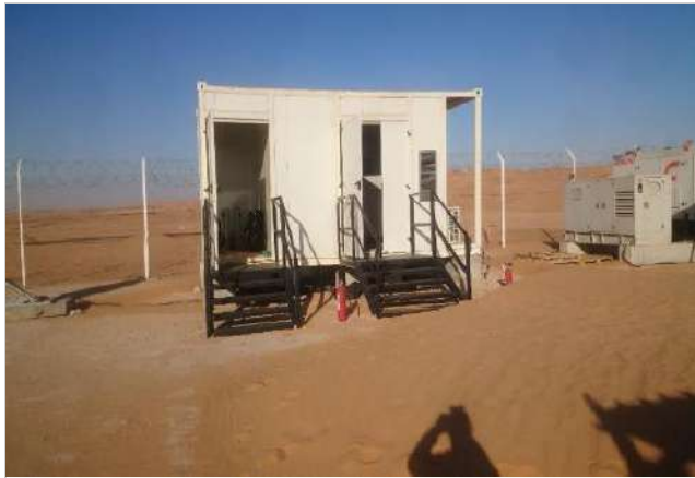
Shelter de commande
