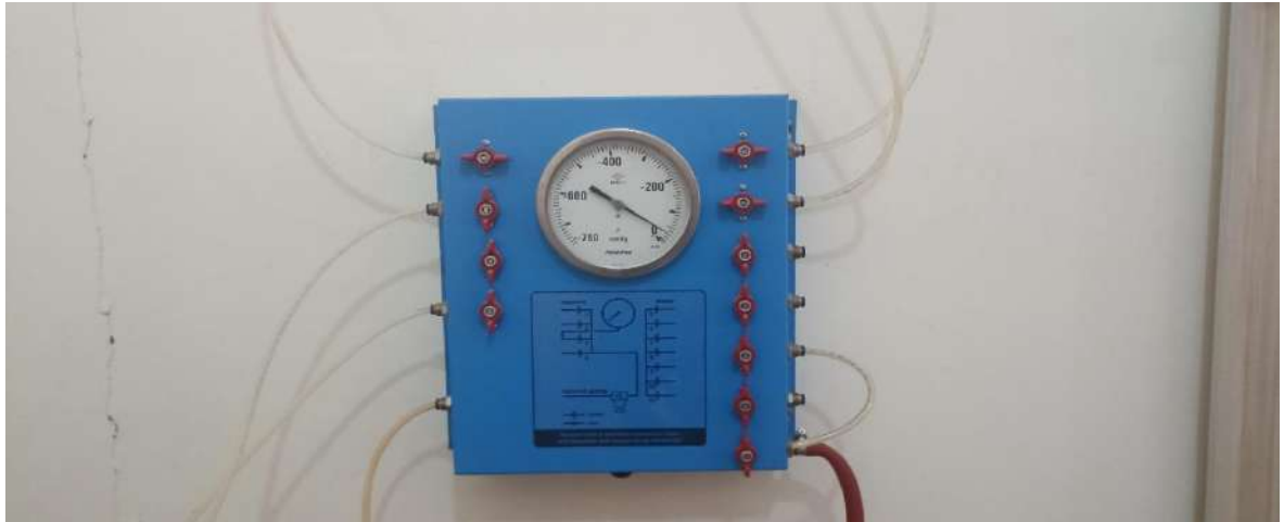
Figure IV.6 : manifold avec cuve d'eau
