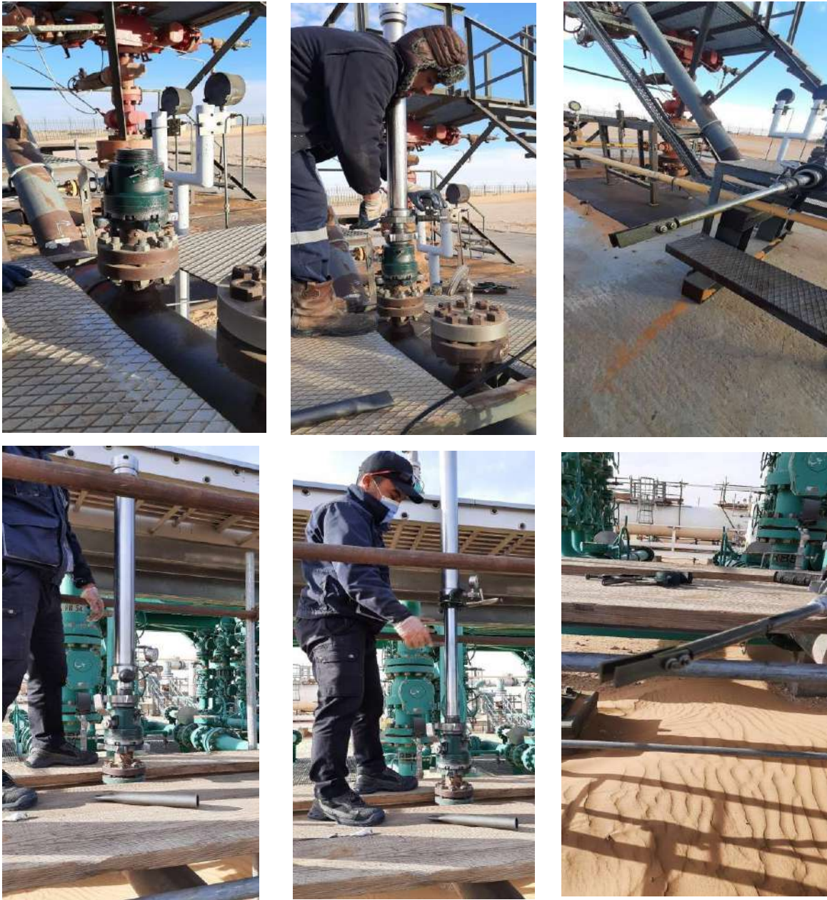
Photo III.9: Opération d'extraction des coupons de corrosion au niveau de la ligne 6'' et arrivée manifold nord du puits RB54 le 27/01/2022
