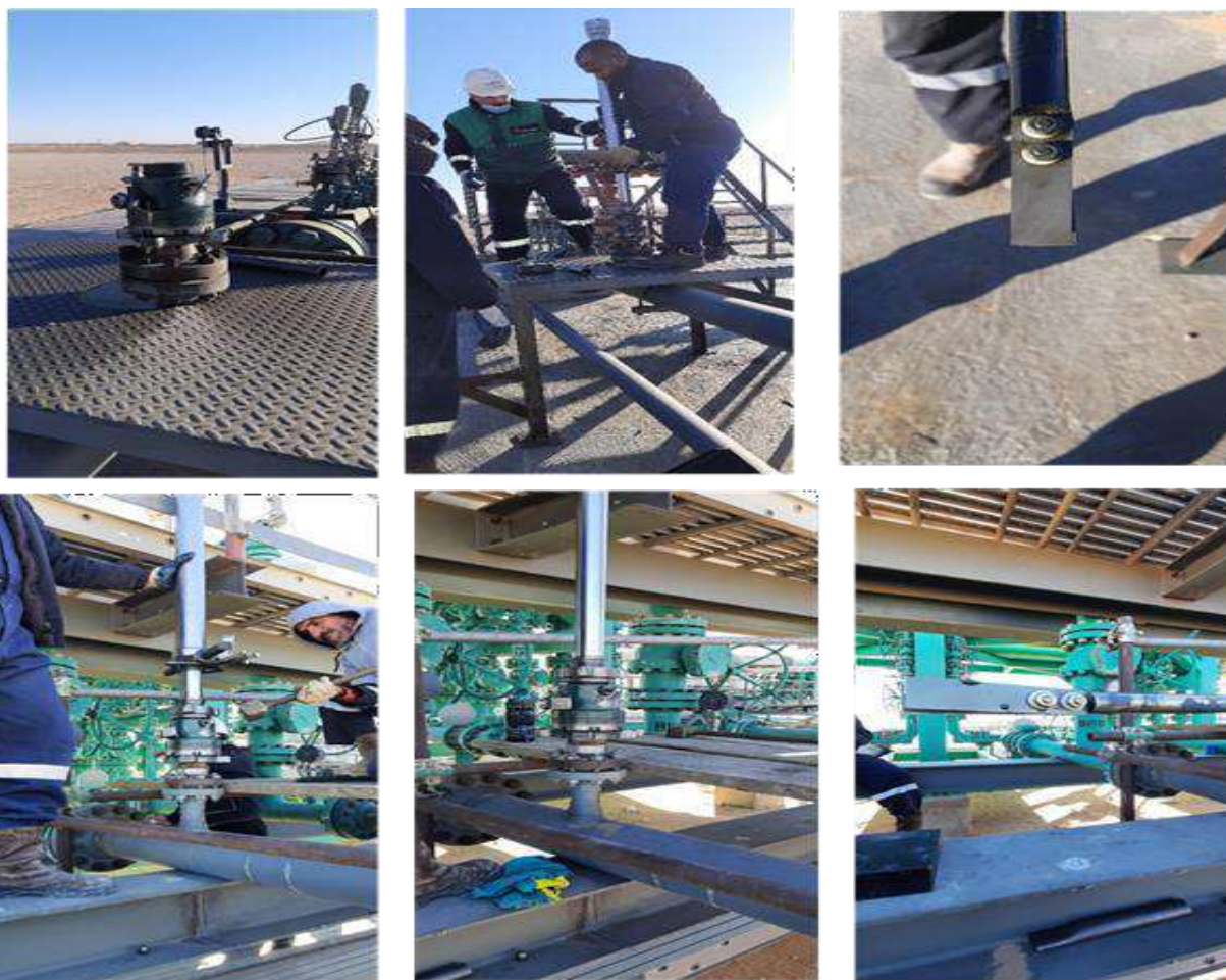
Photo III.7 : Opération d'extraction des coupons de corrosion au niveau de la ligne 6'' et arrivée manifold sud du puits RB64bis le 23/01/2022.
