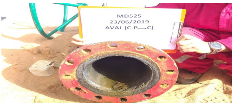
Figure IV.9 : Dépôt en aval ENMAX. [2]
