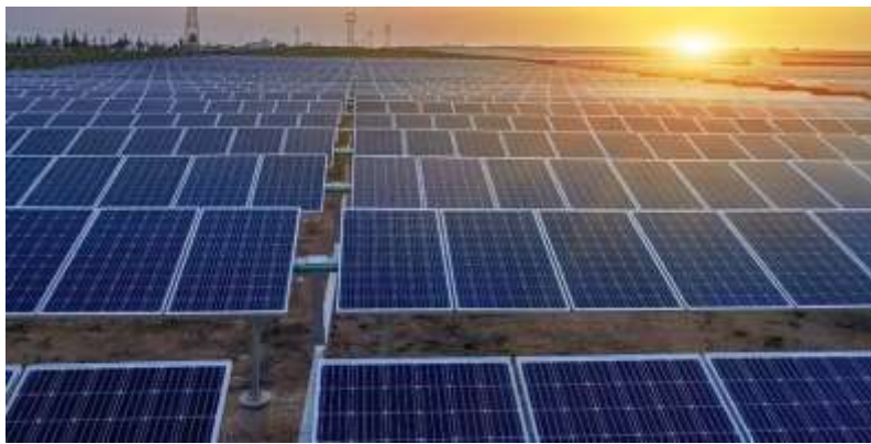
Figure 1.3 : Un générateur photovoltaïque
