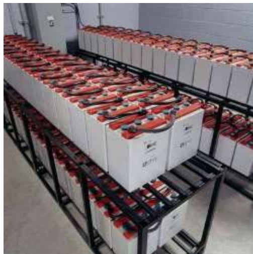
Figure 1.5 : Banque de batterie
