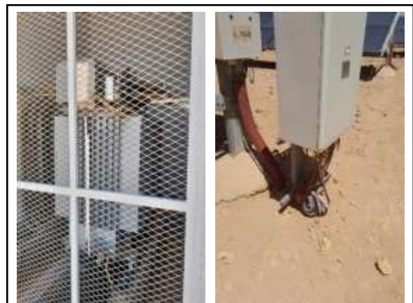
Figure 2.4: Risque lie à l'électricité
