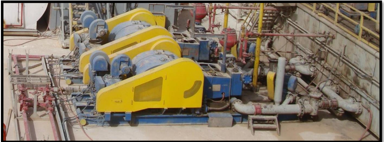
Fig. I.4 : La pompe à boue
