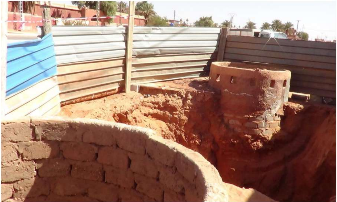
Figure 29: Effondrement foggara Bendraou dans Aoulef
