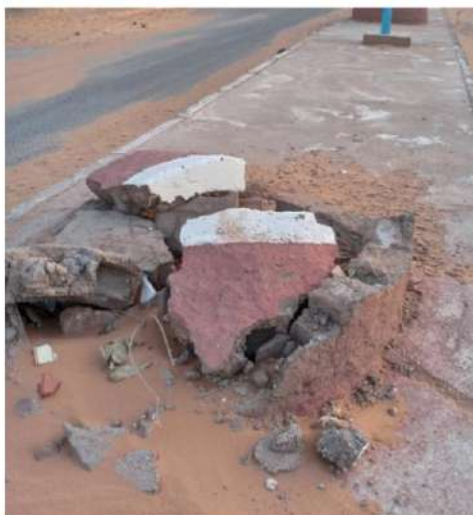
Figure 32: Vandalisme des puits
