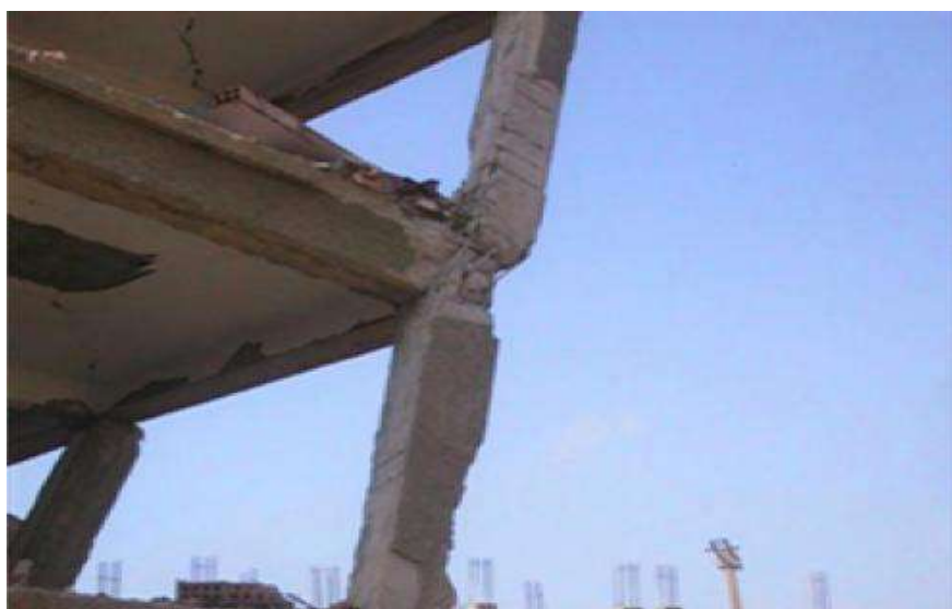
Figure 2.24 : Boudouaou – cisaillement des nœuds Séisme de 2003, Boumerdes, Algérie[13].
