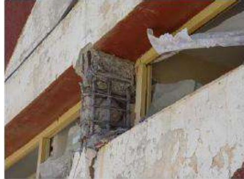
b- Destruction par cisaillement du poteau court
