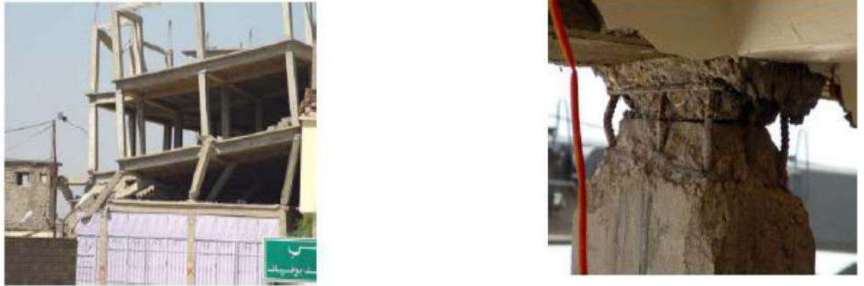
Figure 2.13 : Pathologie des poteaux endommagés par le séisme de Boumerdes (rupture fragile) a- cisaillement des poteaux de l'étage intermédiaire b- Destruction de l'extrémité du poteau
