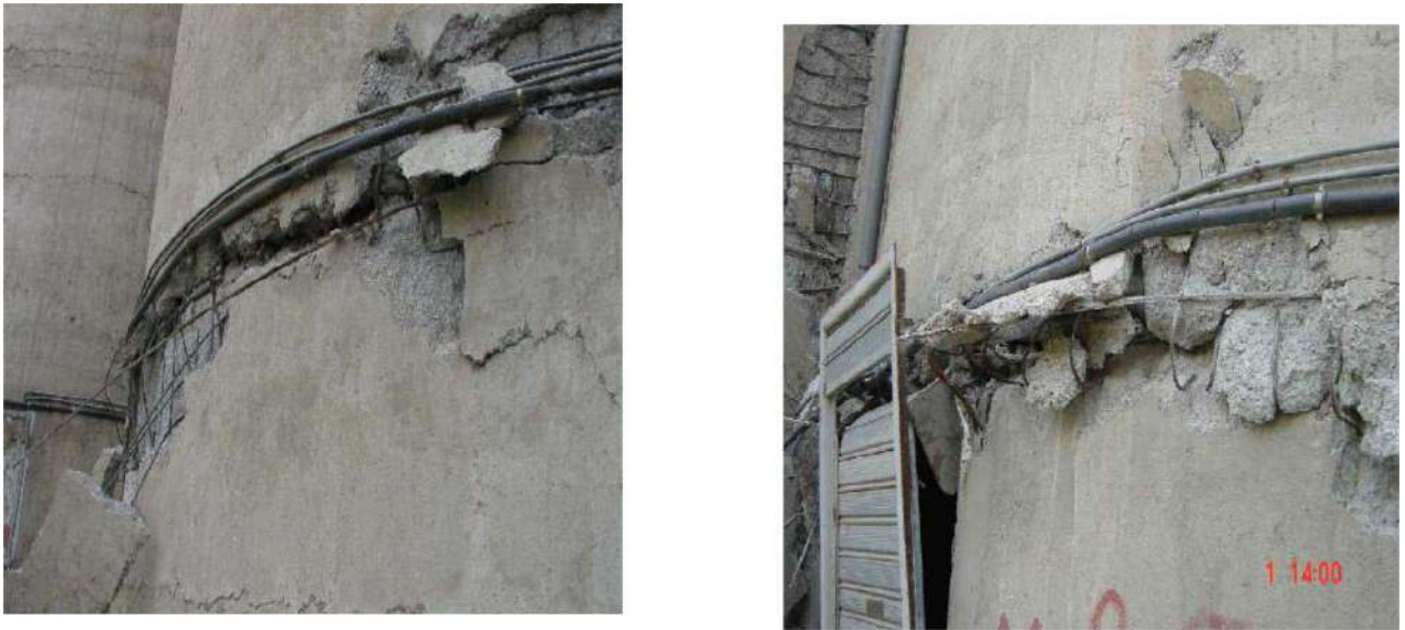
Figure 2.28 : l'écrasement du béton et le flambement des armatures[13].
