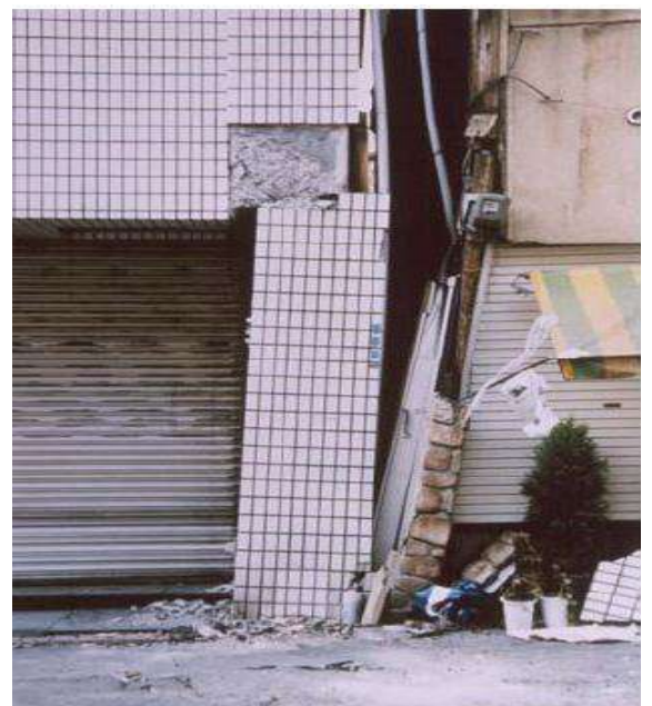
Figure 2.11 : Entrechoquement de bâtiments pour cause de joint PS trop étroit au regard des déplacements réels. [13].
