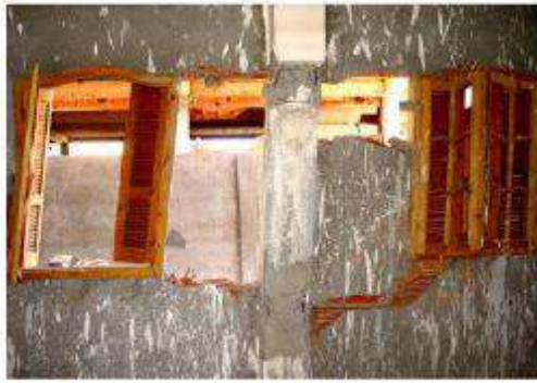
a- poteaux courts en raison de la construction adjacente
