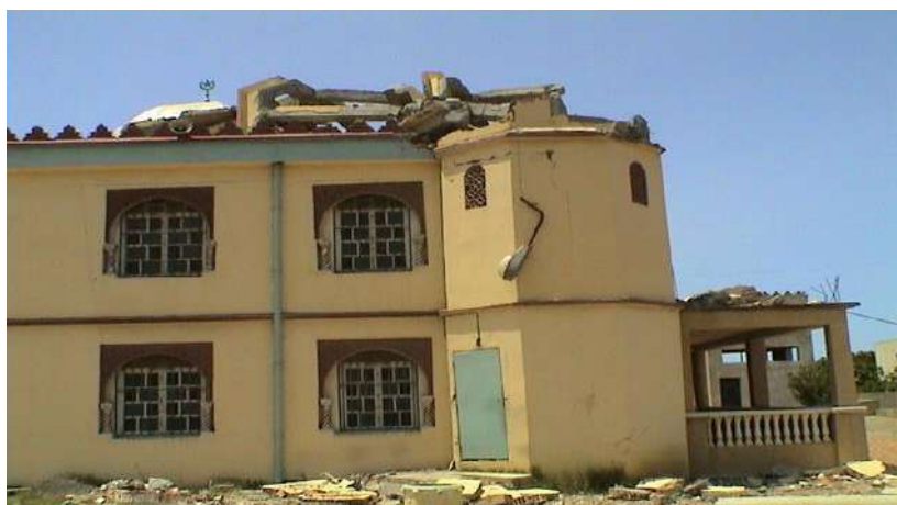
Figure 2.6 : Mosquée de Boudouaou – Minaret effondré Séisme de 2003, Boumerdes, Algérie[13].
