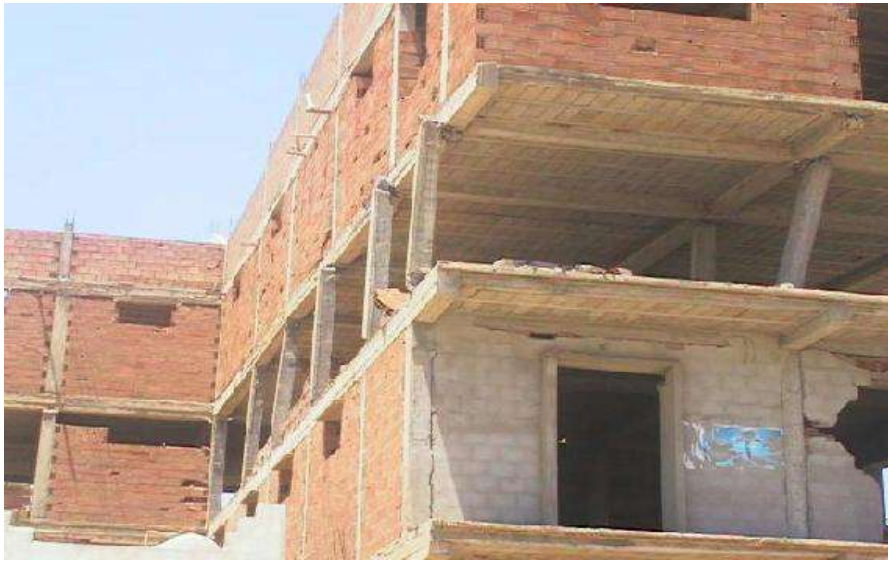
Figure 2.10 : Cisaillement des poteaux d'une construction à Bordj el bahri. Séisme de 2003, Boumerdes, Algérie[13].
