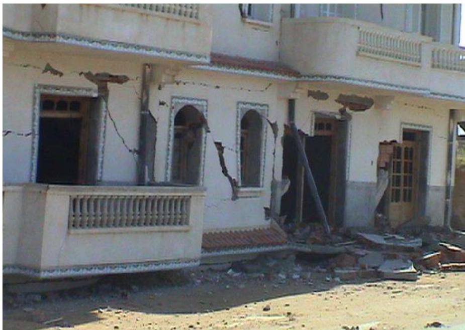
Figure 2.9 : disparition du rez de chaussée (RDC est effondré complètement (étage souple)), Zemmouri ville – Séisme de 2003, Boumerdes, Algérie[13].
