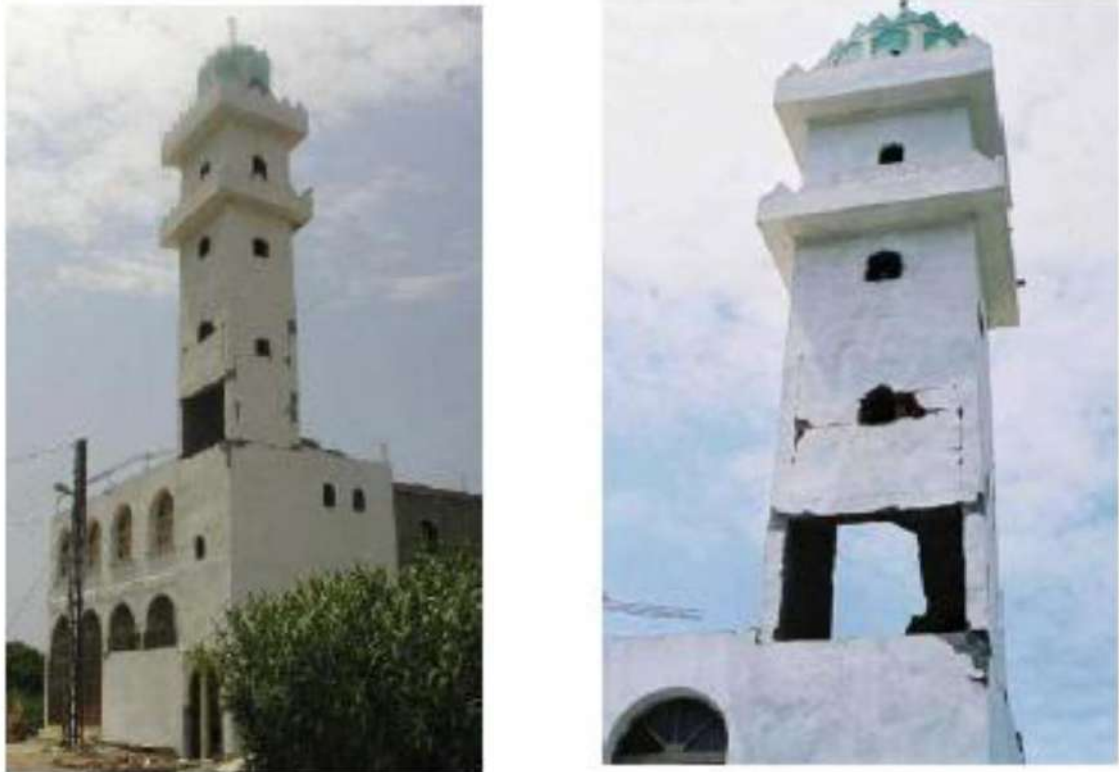
Figure 2.7 : la mosquée de la ville de Zemmouri -minaret effondré séisme de 2003, Boumerdes, Algérie[13].
