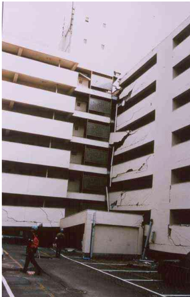
Figure 2.2 : Dommages dans les angles rentrants dus aux oscillations différentielles (séisme de Kobé, Japon 1995) [13].
