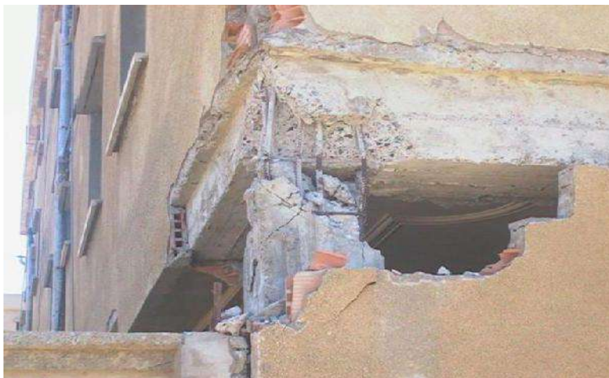
Figure 2.23 : Bordj el bahri – formation de rotule plastique Séisme de 2003, Boumerdes, Algérie[13].
