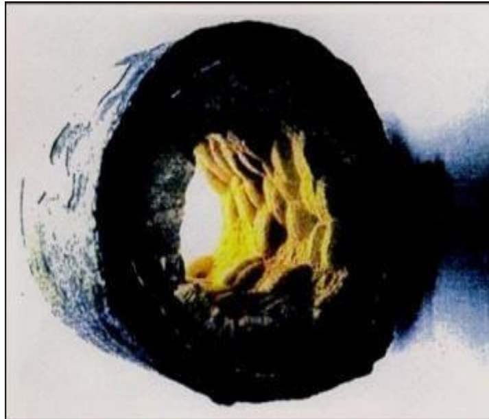
Figure I.1: Dépôt de sulfates
