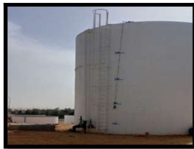
Figure III.9: Bac de stockage qui alimente l'unité d'osmose inverse.
