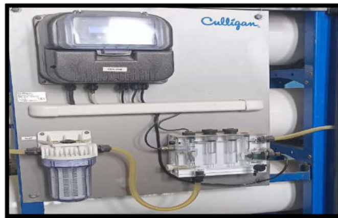
Figure III.19: Panneaux de régulation et de contrôle du CHLORE.
