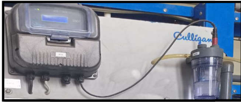
Figure III.18: Panneau de régulation et de contrôle du PH.
