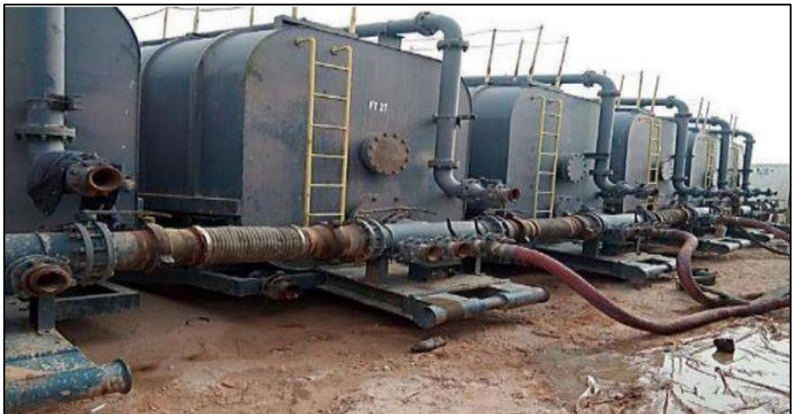
Figure 2-13 : Réservoir d'eau (FRAC TANK). [12]
