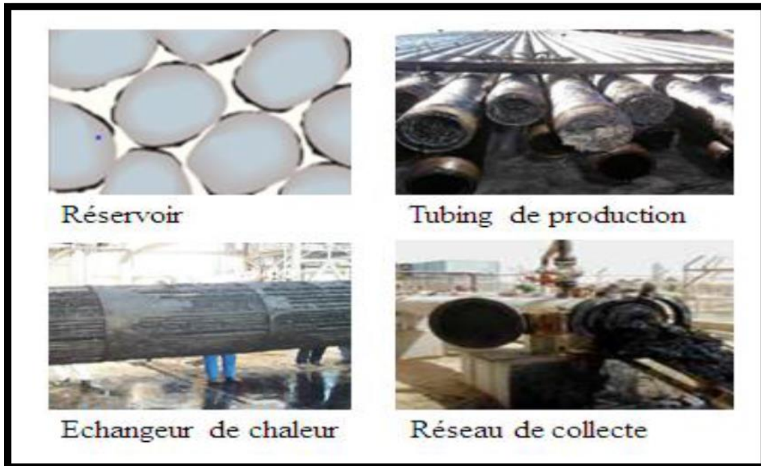
Figure I.12 : Localisation des dépôts d'asphaltène [29].
