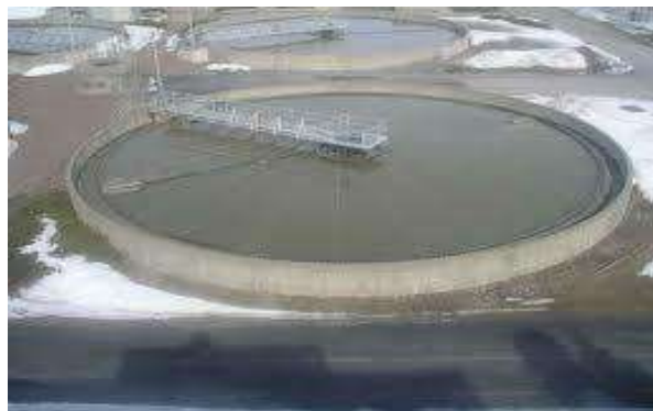
Photo 2-3 : décanteurs primaires circulaires alimentés par le centre
