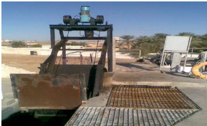
Photo 2-1 : Le Dégrillage et tamisage
