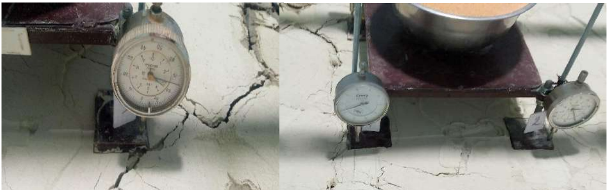
Figure (IV.5) : L'effondrement des semelles due au gonflement du sol argileux.
