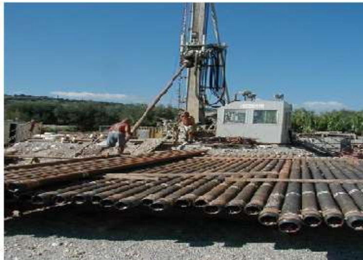
Figure I. 15: Les tiges de forage
