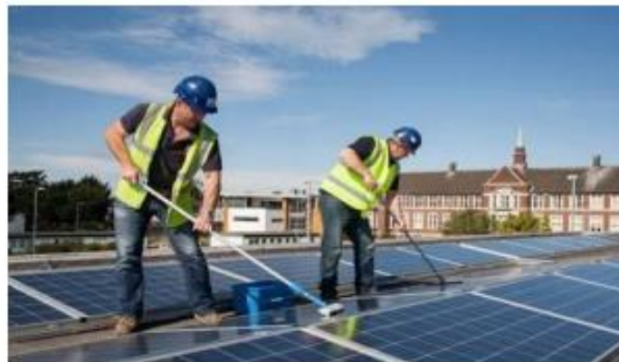
Figure II.1 : Nettoyage manuel des panneaux solaires .[10]
