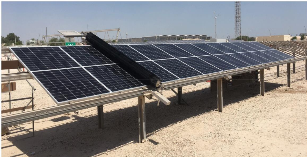
Figure II.4 : Configuration du banc d'essai et du robot. [11]
