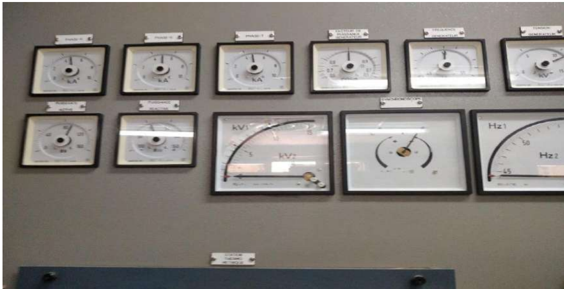
Figure III.20. Les appareils de mesure des paramètres électriques
