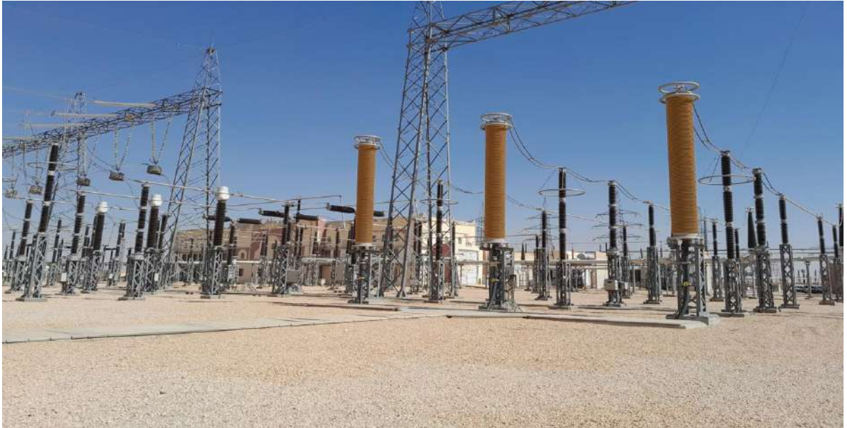
Figure III.2 : Poste de transformation 220/400 kV de la centrale à gaz Ouargla Hassi Messaoud.
