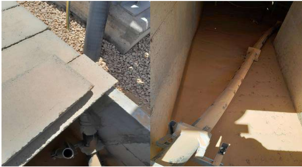
Figure III.8. L'emplacement de câble souterrain dans le caniveau.
