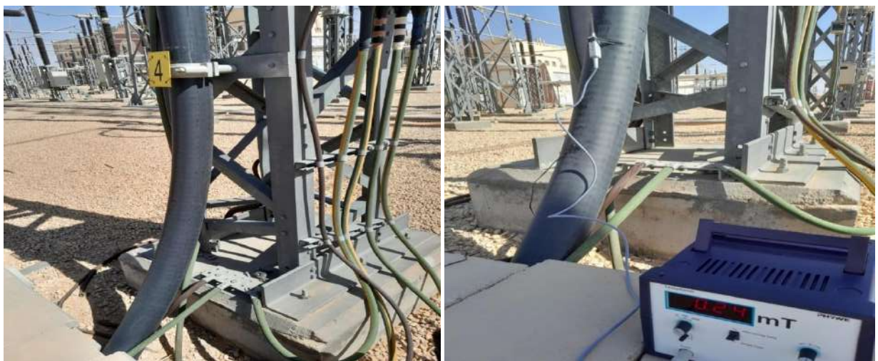
a- Câble souterrain de la phase 4
