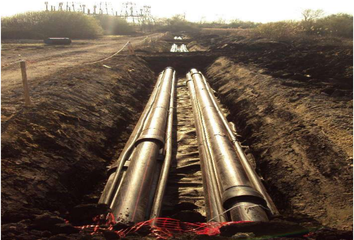
Figure I.3. Ligne électrique souterraine [8].
