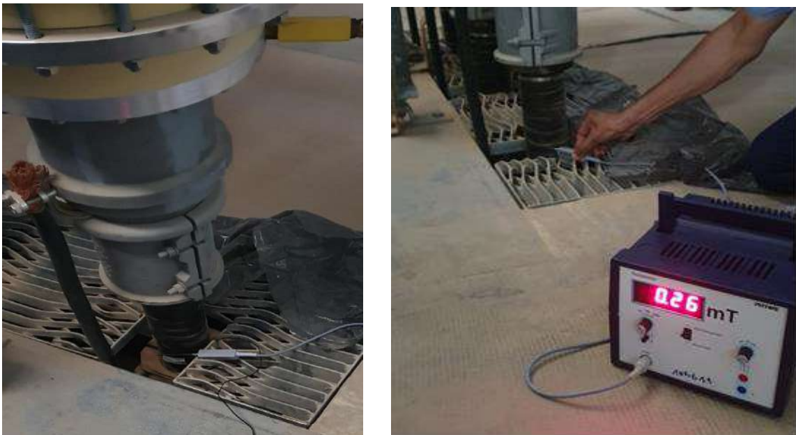
Figure III.24. Mesure du champ magnétique d'un câble souterrain 220 kV à l'aide d'un Teslamètre.
