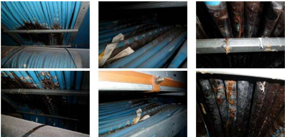
Figure I.16. Câbles localement endommagés
