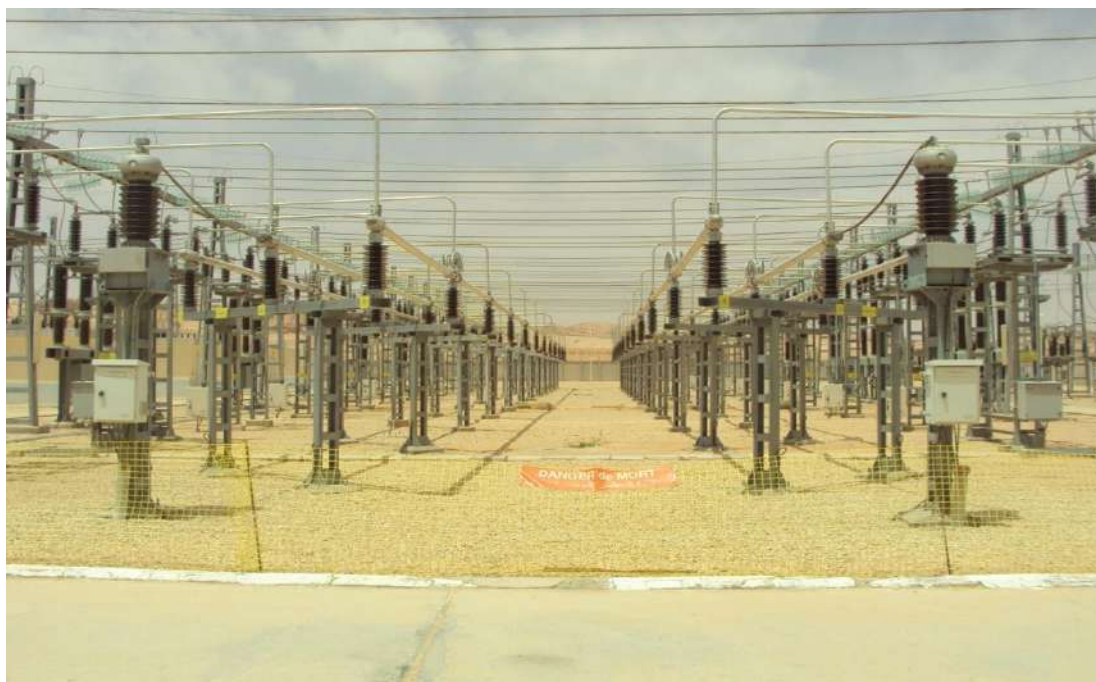
Jeux de barre 60 kV N° 1 et 2
