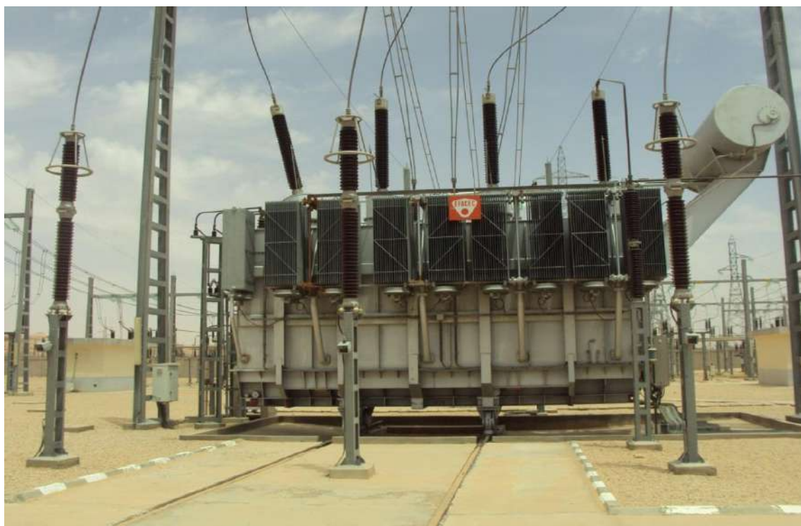
Transformateur de puissance 220/60/10 kv
