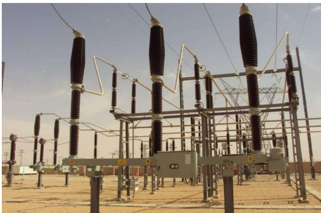
Disjoncteur 220 kv (triph)
