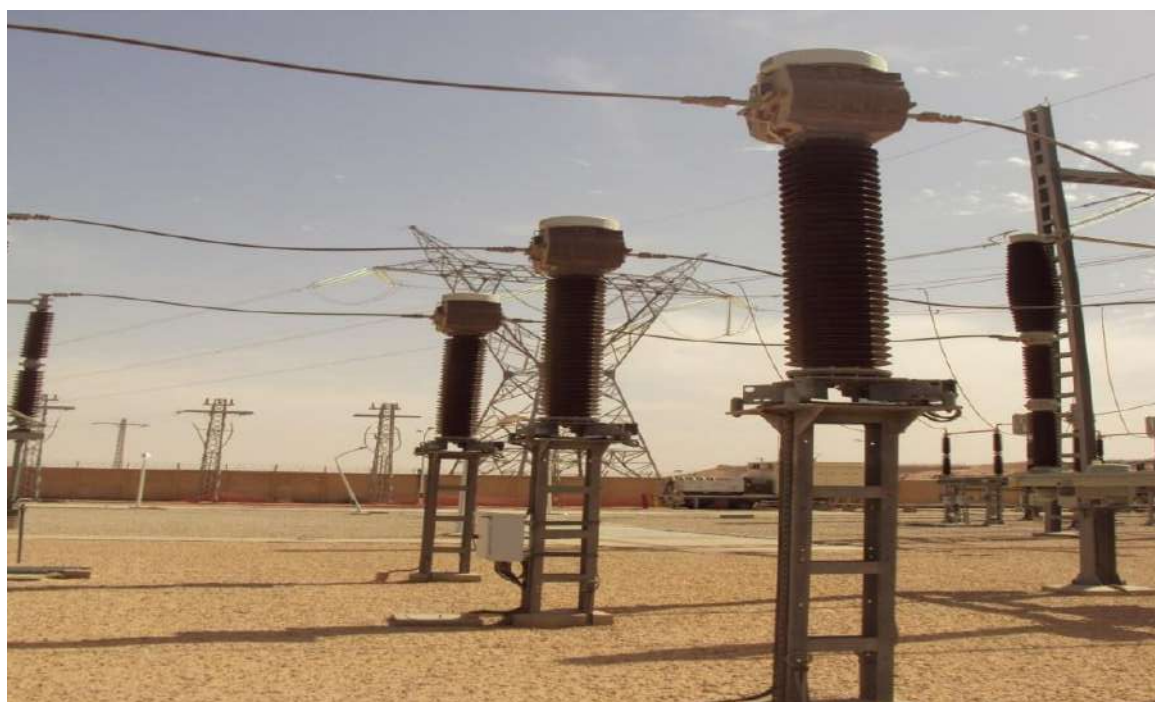
Transformateur de courant 220 kv
