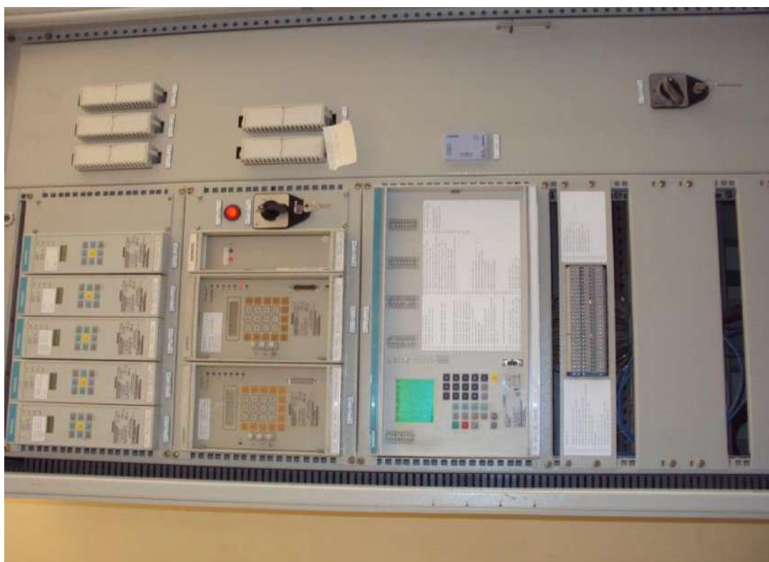
Protection transfo 220/60/10 kv n 1
