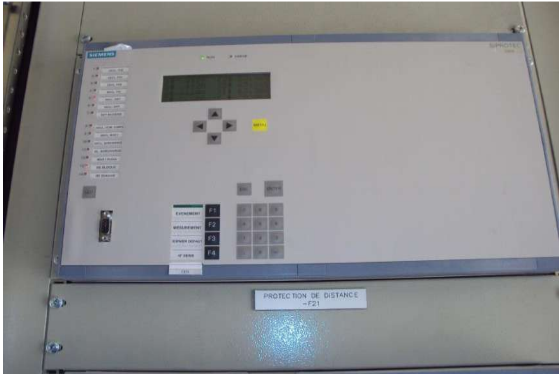
Protection de distance(Départ 60 kv)
