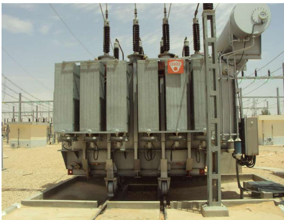
Transfo 60/30 kV N° 04
