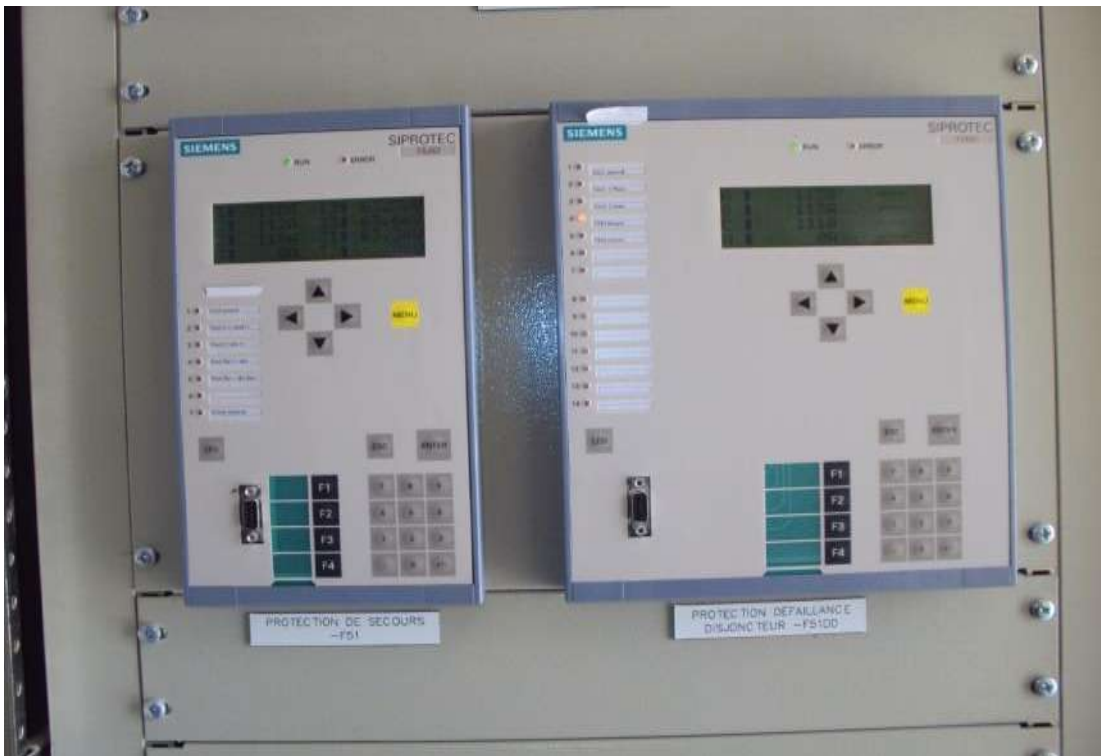
Protection de défaillance disjoncteur (PDD)
