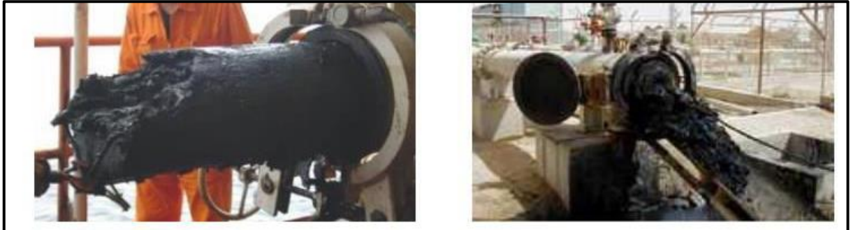
Figure I.17 : Dépôt asphaltène après une opération de raclage.
