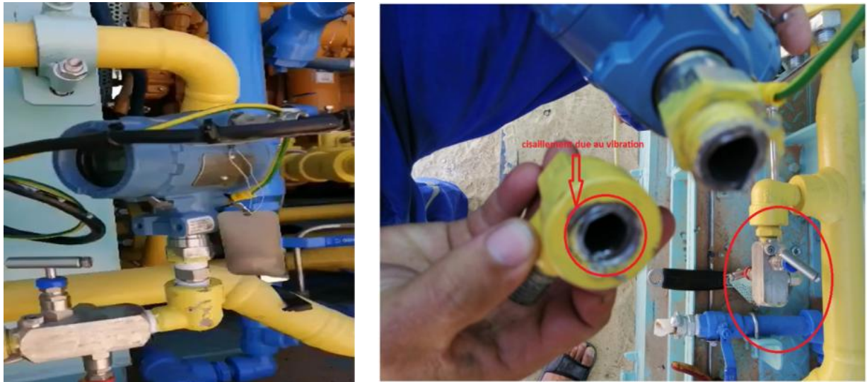
Figure III .20: Problèmes fixé sur place (HSE)
