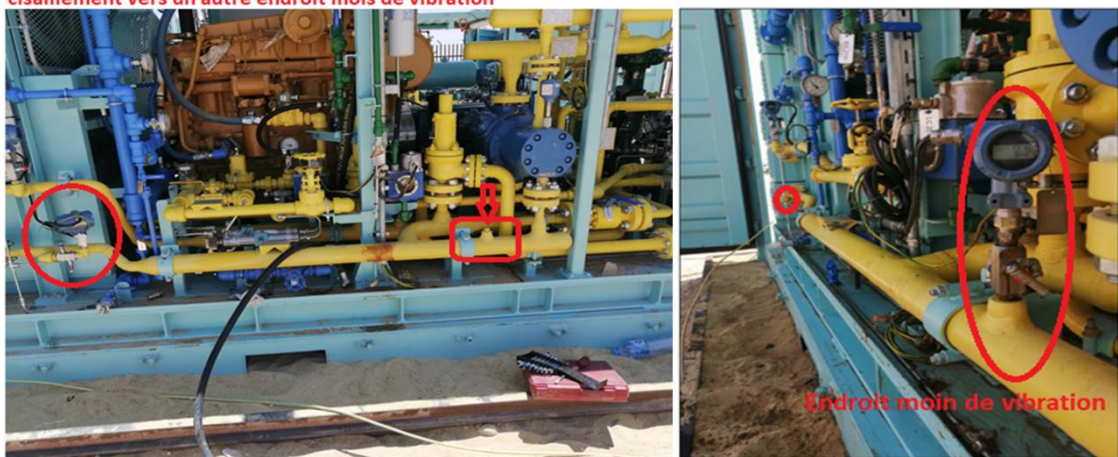
Figure III.21: Problèmes liées au vibrations
