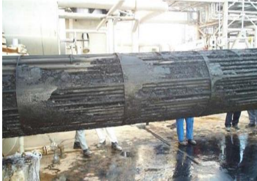
Figure II- 6 : Dépôt d'asphaltène dans un échangeur de chaleur.
