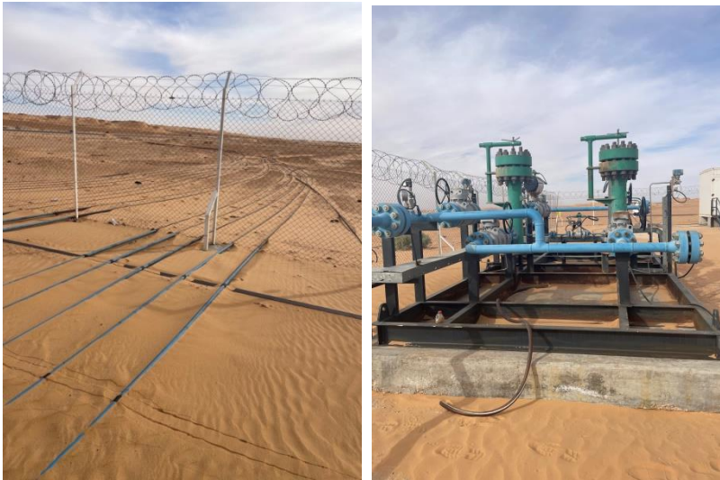
Figure III.3 : Les lignes d'injections d'eau Figure III.4 : Filtres
