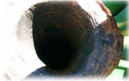
Figure II. 2 : Dépôts de caso4 dans une pipe de pétrole
