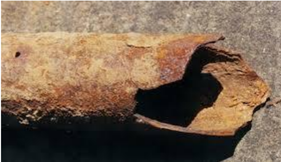
Figure (II.1) : Exemple sur la corrosion d'une pipe. [3]
