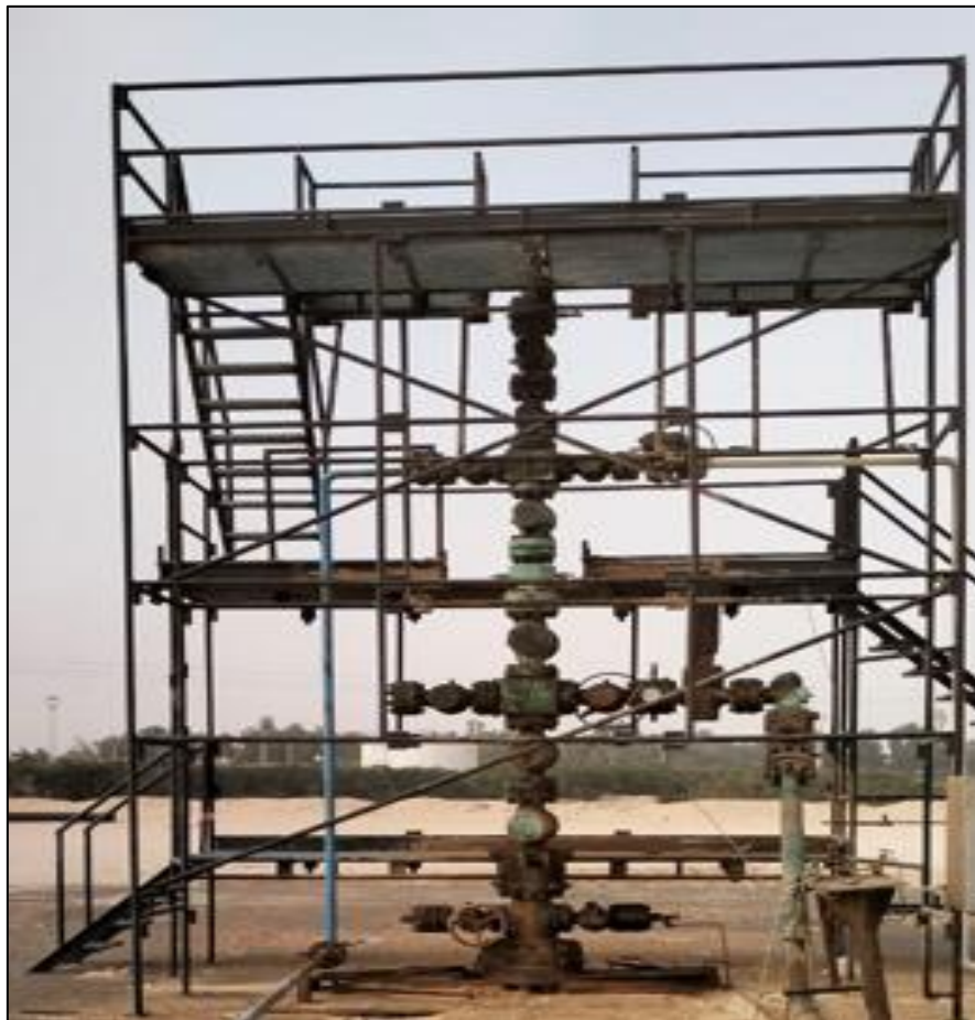
Figure (III-7) : Tête de puits.
