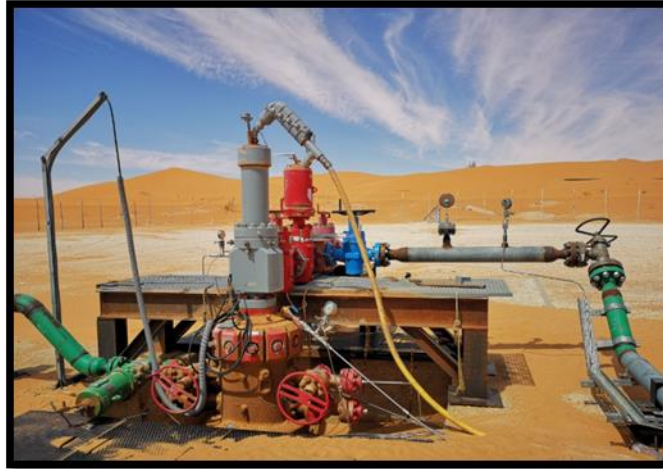
Figure IV.14 : Tête de puits A6
