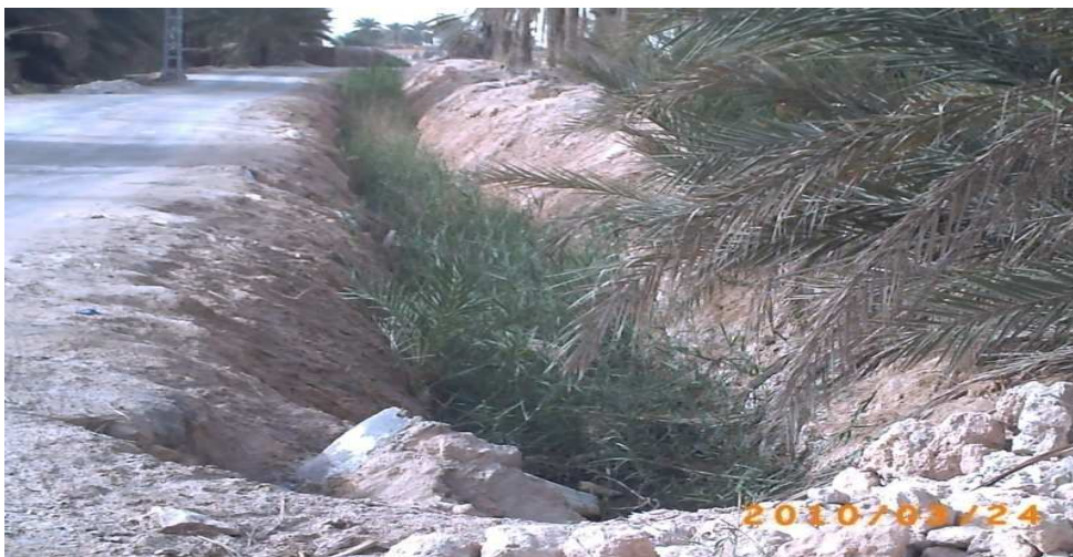
Photo N°10 : Drainage non fonctionnel (Chott)
