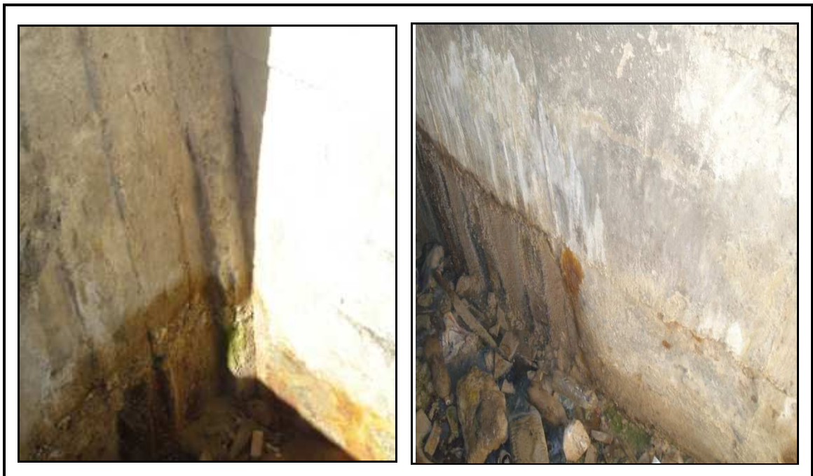
Photo (III, 8): Infiltration des eaux de la nappe et aspect de corrosion
