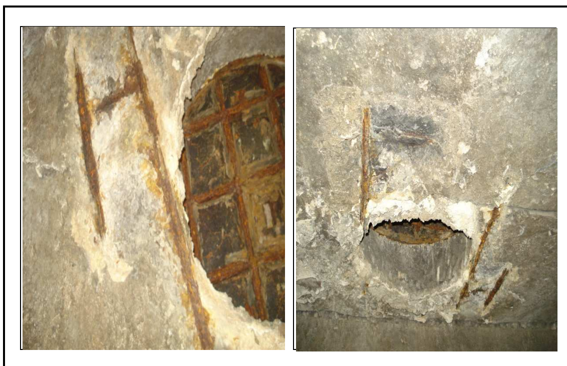
Photo (III, 4): Détail d'une forte corrosion des aciers corrodé et du tampon.
