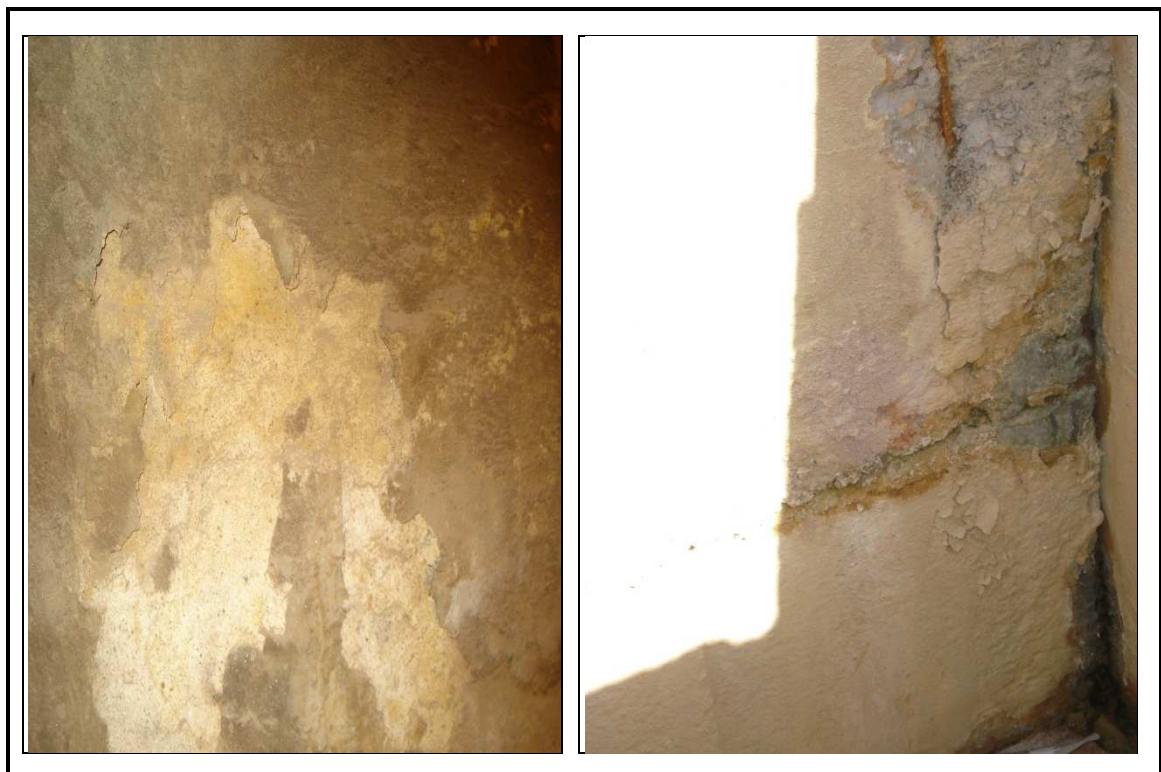
Photo (III, 2): Détail d'épaufrure et d'éclatement de béton.
