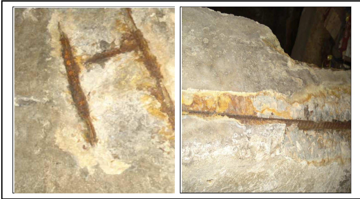
Photo (III, 5): Détail d'une forte réduction de section des aciers corrodé.
