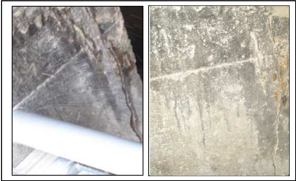
Photo (III, 7): Illustrations de fissuration verticale - l'entrée du couloir- Des fissurations, d'ouvertures plus ou moins importantes, verticales et horizontales.
