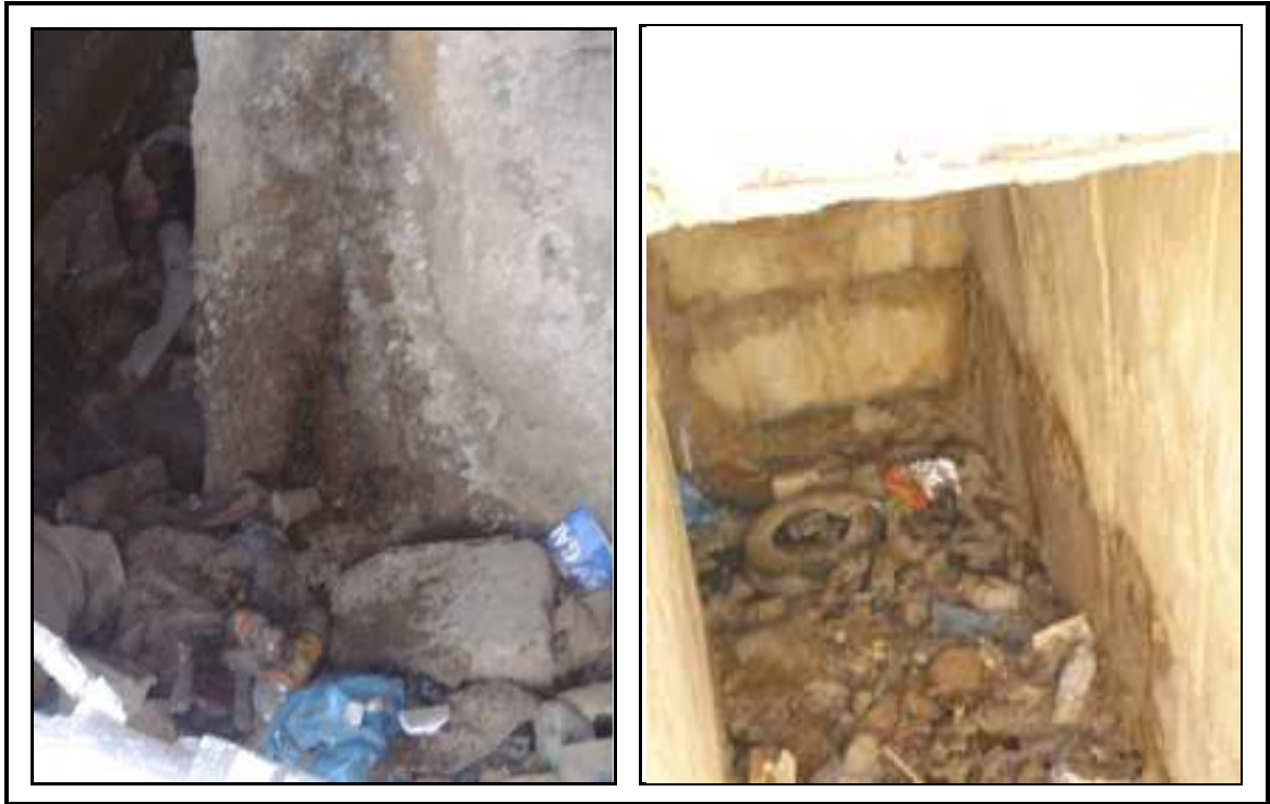
Photo (III, 9): Illustration de l'infiltration d'eau de la nappe phréatique à la galerie.
