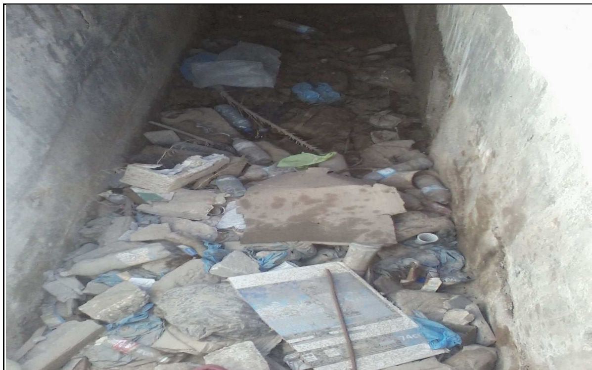
Photo V : Les ordures à la sortie de la galerie (V -a)
