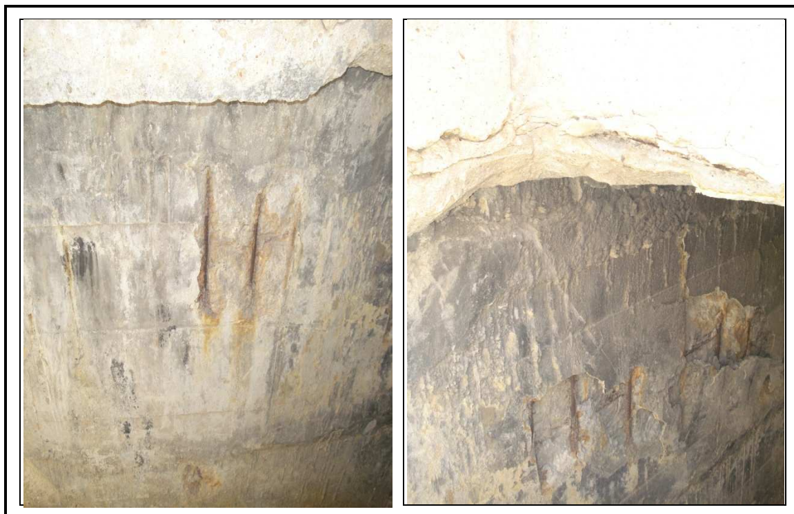
Photo (III, 3): Illustration des éclatements sur mur.
