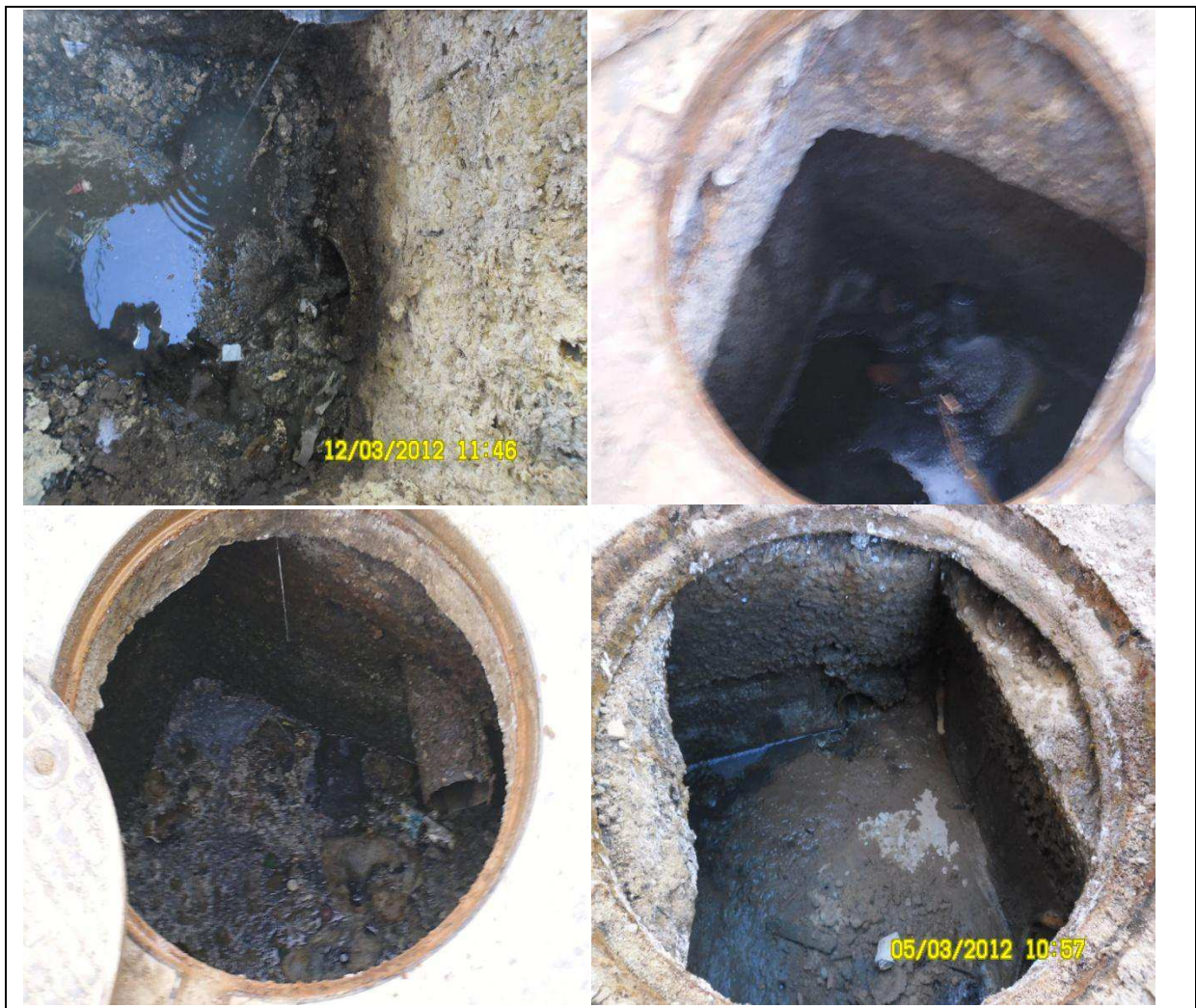
Photos VI : L'état des regards moyen chargés des dépôts.
