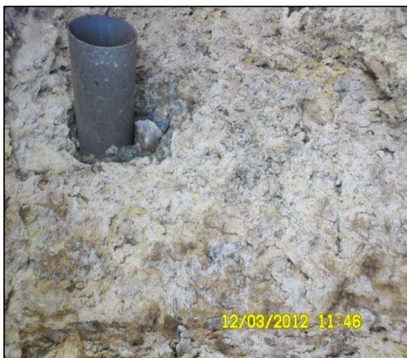
Photo XX: Dépôts de H 2 S sur les parois du regard.
