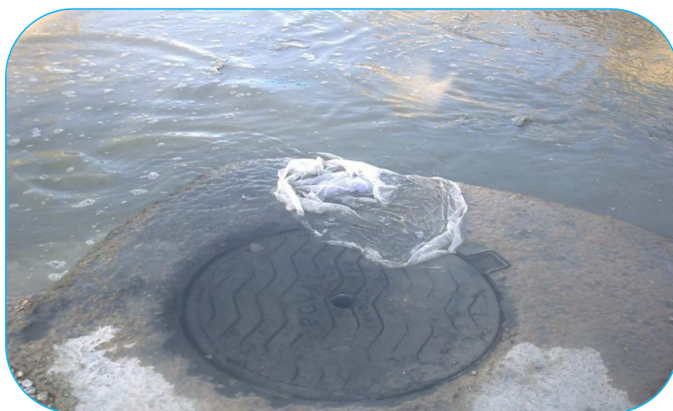
Photo 3-1: Débordement des eaux usées de collecteur BE sur la rue de Mustapha Ben Boulaïd (03/03/2012).
