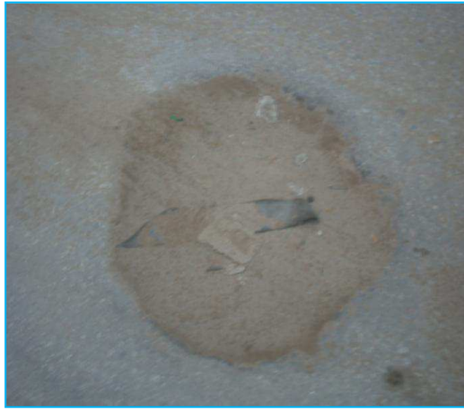
Photo 4-9 :L'état de regards non aéré (03/03/2012).
