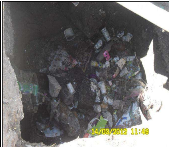
Photo XVII: rejet de divers types de déchets dans le regard d'eaux usées.
