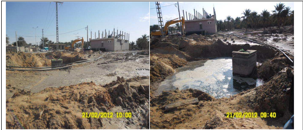
Photos XI: Affaissement de chaussée à cause d'effondrement à l'amont de collecteur A à l'Ain Beida.
