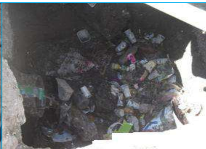
Photo 4-3: Présence de divers types de déchets dans le regard (04/03/2012).
