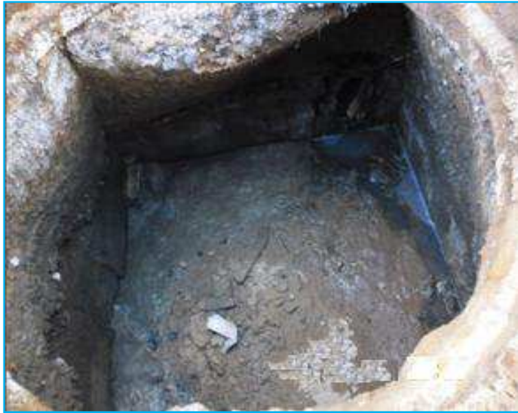
Photo 4-4: Présence des dépôts des sables (03/03/2012).
