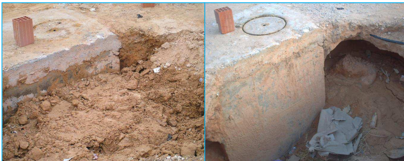
Photo 4-1: Affouillement de chaussée au niveau d'un regard récent à Sokra (10/03/2012).
