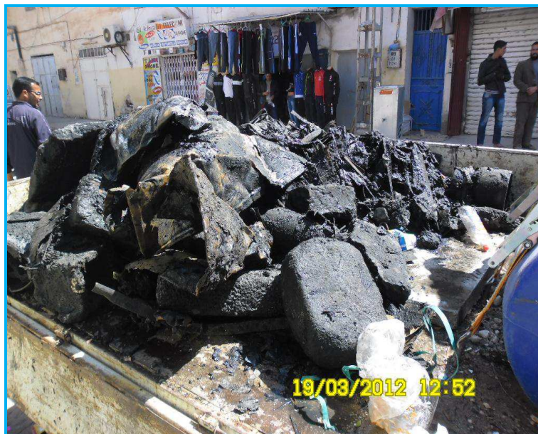
Photo 4-5: Encrassement des réseaux par des dépôts des matériaux solides (19/03/2012).
