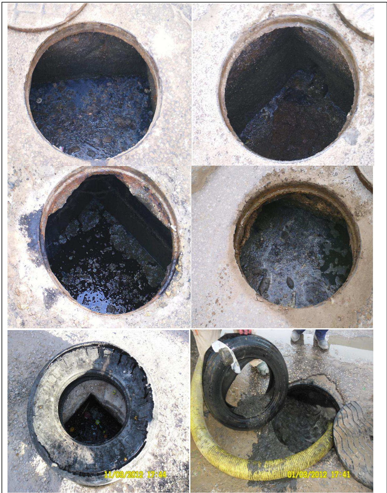
Photos V : L'état des regards presque totalement chargés par des dépôts.
