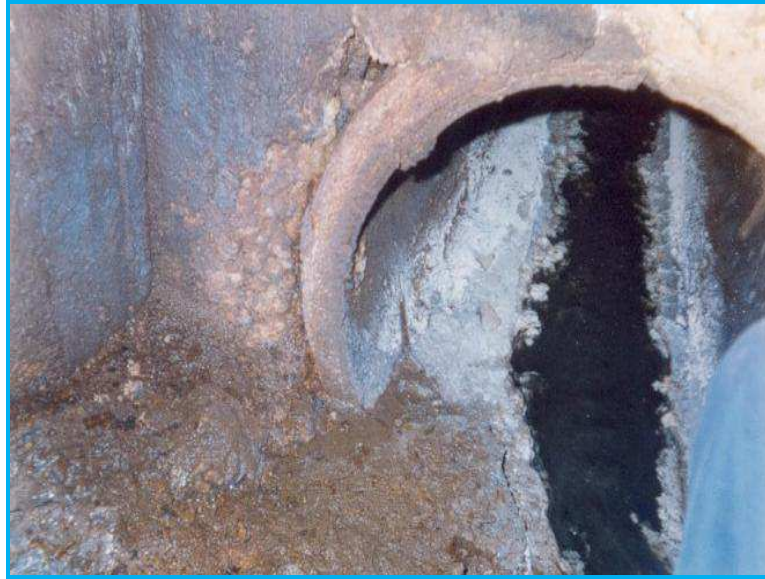
Photo 4-6: Mauvaise qualité de mise en œuvre du joint de conduite à la paroi de regard.
