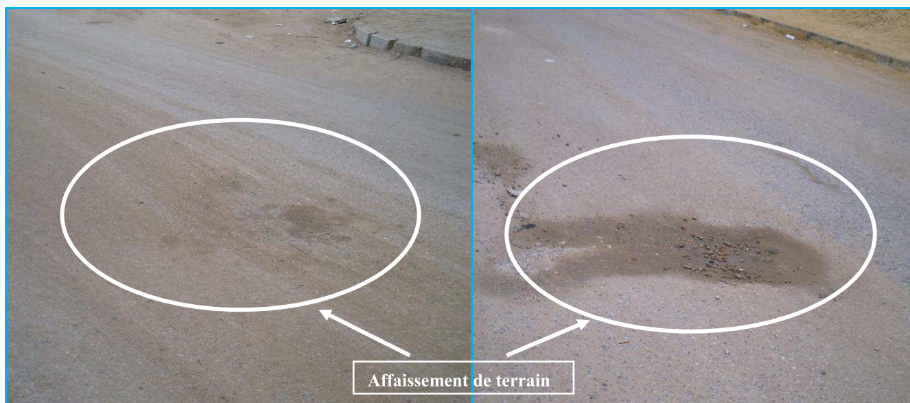
Photo 4-8: Affaissement de terrain au niveau de la rue
