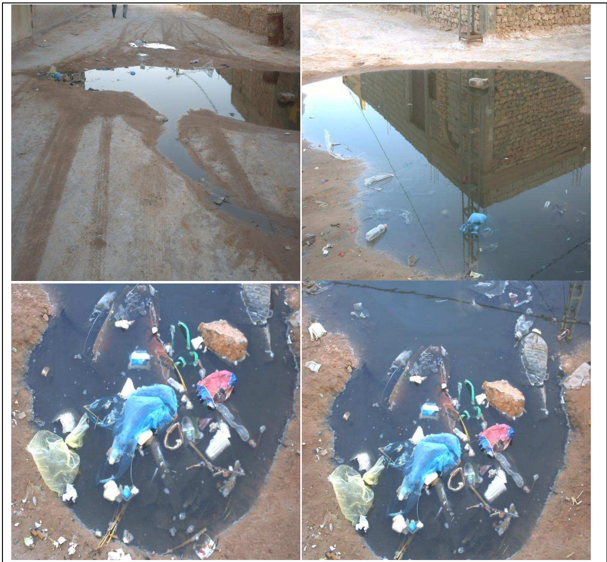
Photos X : Débordement d'un regard situé à coté de la mosquée d'El Kouatre (El Ziyayna).
