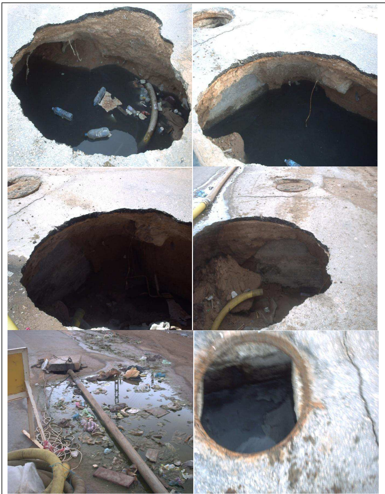
Photos VIII : Affaissement de chaussée sur la rue de de Zaoui Bouhafs à cause d'effondrement à l'aval de collecteur BO au Sidi Bougoufala.
