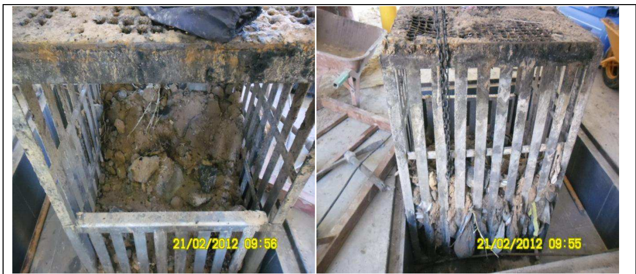
Photos XIII : Le déchet solide retenu par le dé grilleur de la station de pompage Ain Beida.
