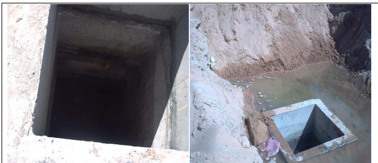
Photos XV : L'état de réhabiliter à l'amont de collecteur A au secteur d'Ain Beida.
