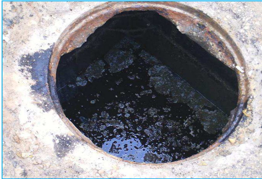
Photo 4-11: Rejet d'effluents agressifs dans le regard d'eaux usées (10/03/2012).
