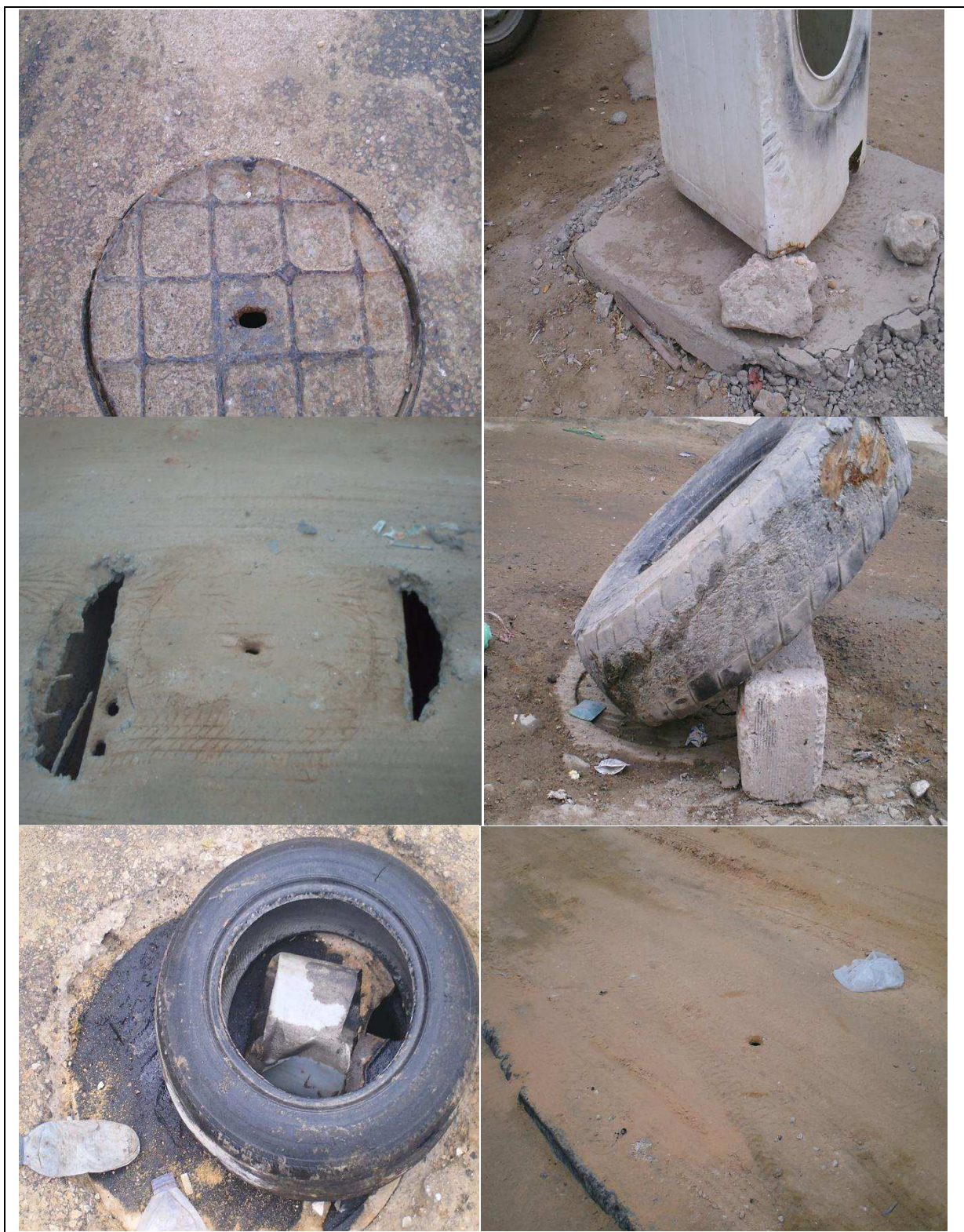
Photos II : Regards à tampon en mauvais état en surface.
