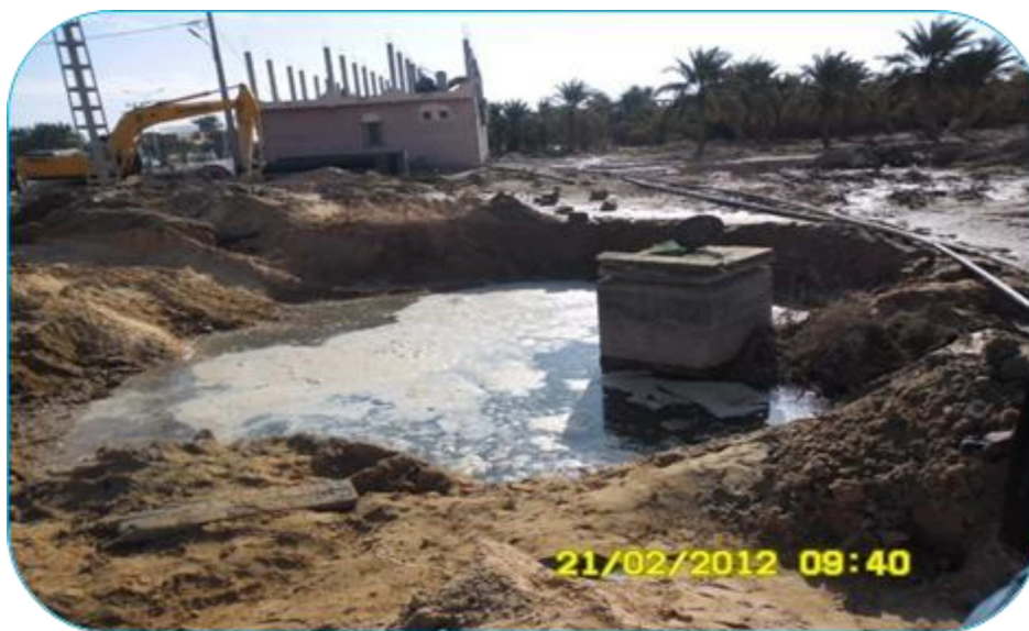
Photo 3 -4: L'effondrement à l'amont de collecteur A à l'Ain Beida (21/02/2012).
