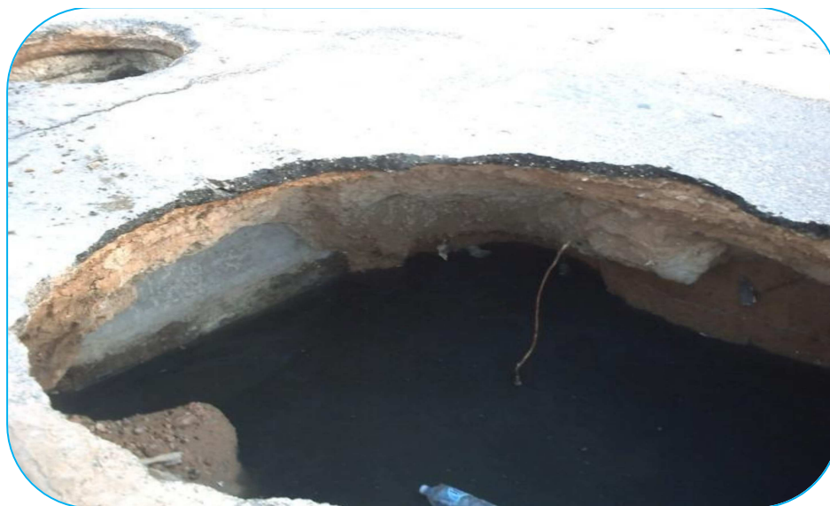
Photo 3 -2: L'effondrement à l'aval de collecteur BO au Sidi Bougoufala (03/03/2012).
