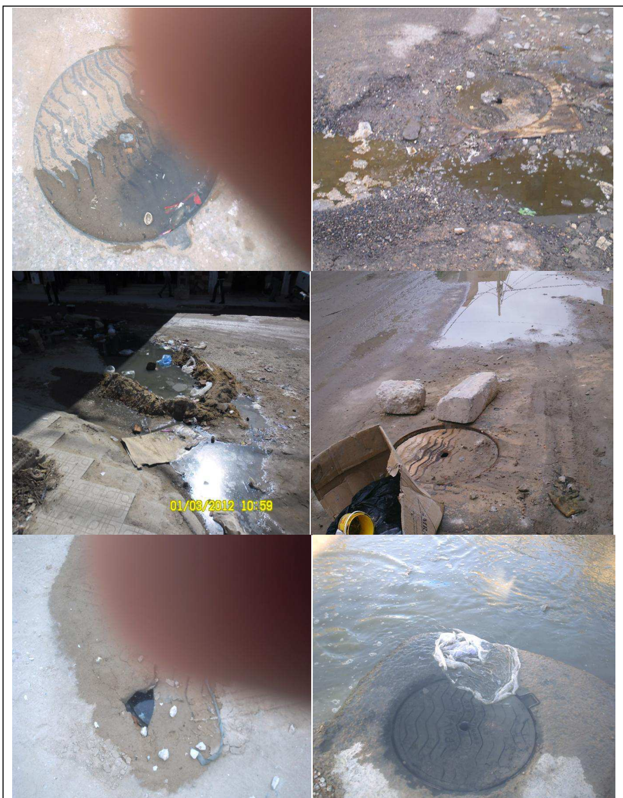
Photos III : Débordement des eaux usées de collecteur BE sur la rue de Mustapha Ben Boulaïd au Sidi Bougoufala.
