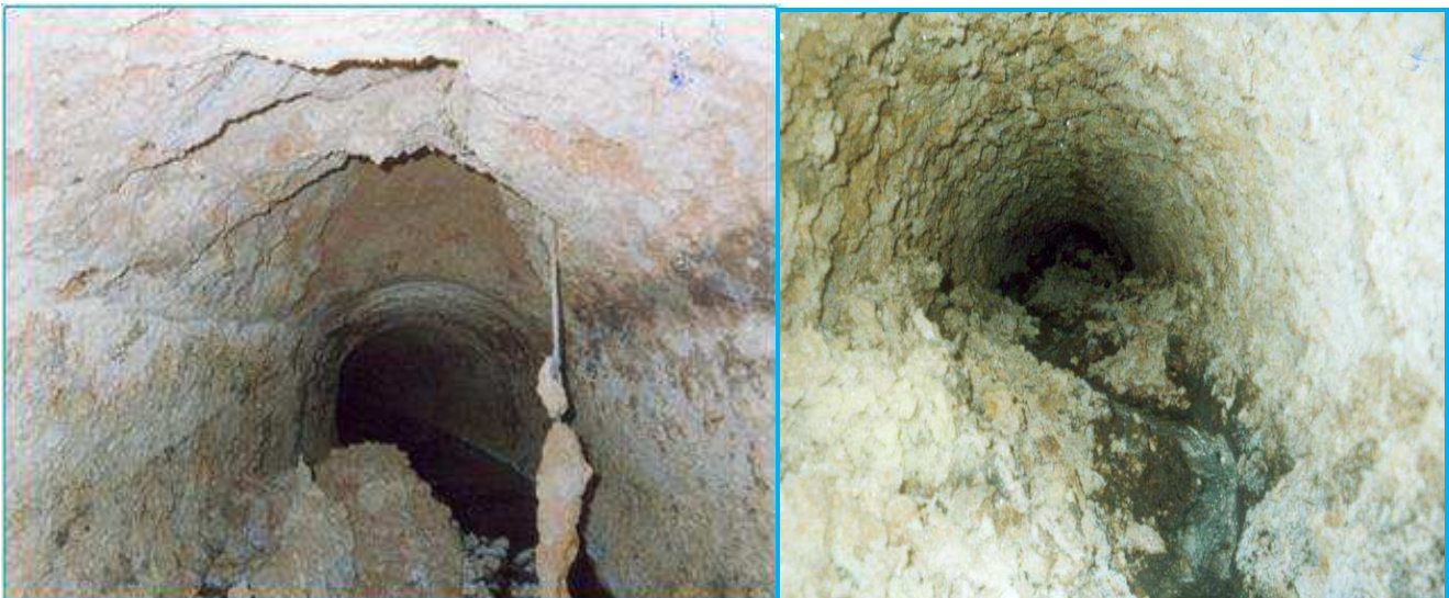
Photo 4-10: Dégradation des conduites par l'effet de gaz de H 2 S
