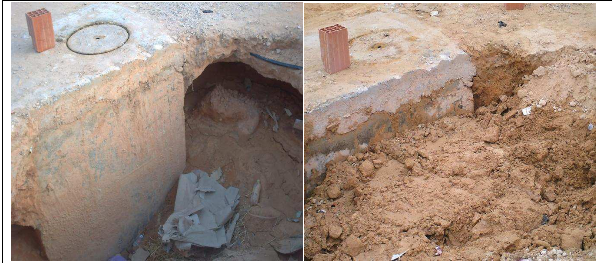
Photos IX : Affaissement de chaussée au niveau d'un regard récent à Sokra.
