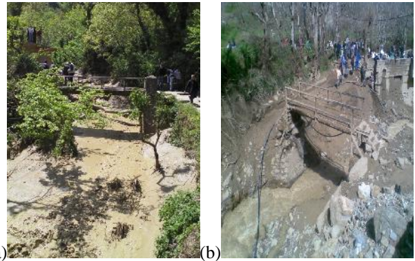
Fig.9. Dégradation d'une passerelle sur l'Oued Azrou N'Thor: (a) en 2012; (b) en 2013
