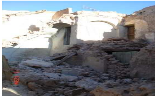
Photo n°3 : Etat de dégradation des maisons du ksar d'Ouargla.
