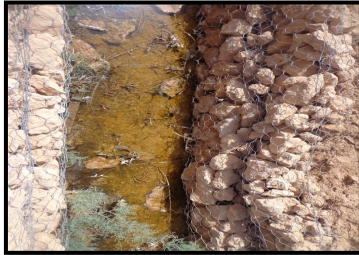
Photo 04. Eau de drainage dans un drain de la ferme de l'université d'Ouargla.
