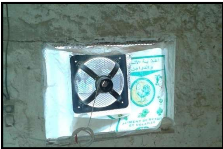
Photo N 09 : Ventilation dynamique
