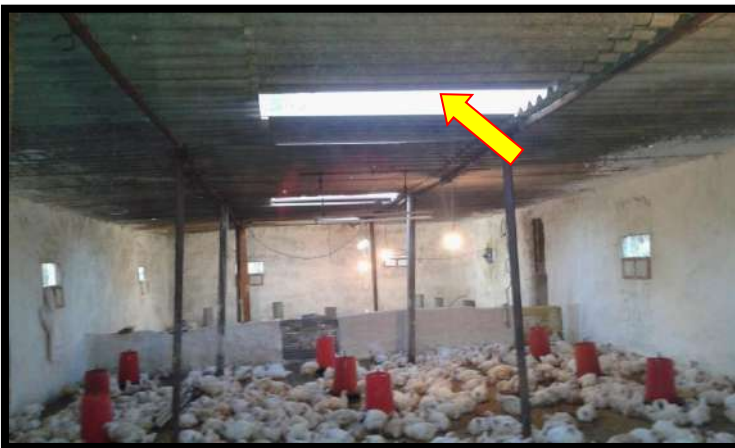
Photo N 03 : Toiture en fer ondulé et présente des ouvertures
