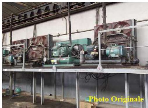
Fig. 22 : Unité de refroidissement (usine 03, 2016)
