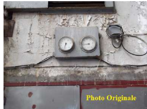
Fig. 24 : Régulateur du couple Tps/T° tunnel de ré-humidification (Usine 02, 2016)
