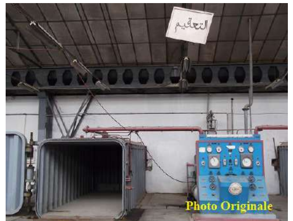
Fig. 30 : Chambre de stérilisation (usine 02, 2016).
