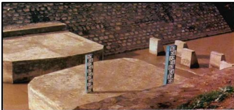
Figure 11. Photo d'un seuil-jaugeur Parshall
