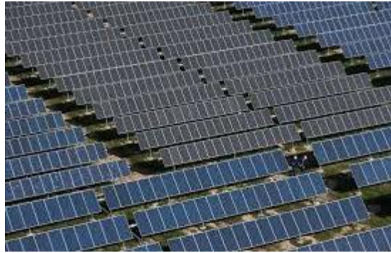
Figure (I.4) : Centrale solaire photovoltaïque[10]
