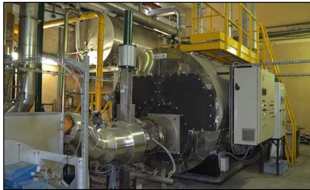
Fig. I.3 : Incinérateur de gaz, fumés et liquides.
