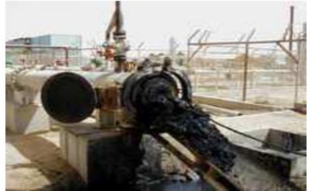
Fig II.8 : Dépôt d'Asphaltène dans le réseau de collecte.
