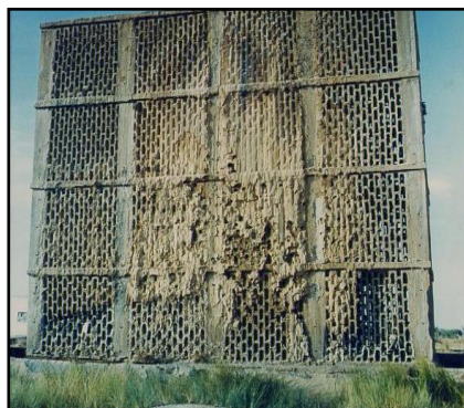
Fig.23 : Photo montre le système refroidisseur (Ancien).
