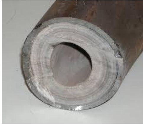
Fig.22 : Photos illustrant les dépôts de tartre dans les canalisations.
