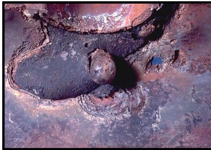
Fig. I.4. Corrosion galvanique au niveau d'une zone de brasage entre la brasure Cu-P et le tube en cuivre
