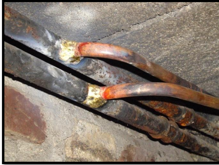
Fig. I.9. Corrosion chimique: Cuivre et acier noir dans une installation
