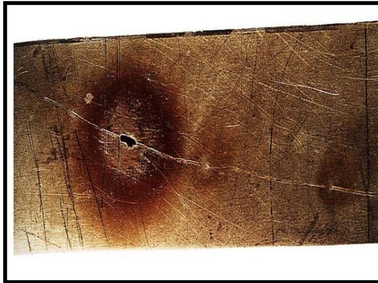
Fig. I.2. Corrosion par piqûres sur la paroi d'une cuve en acier Inoxydable austénitique Cr18-Ni10
